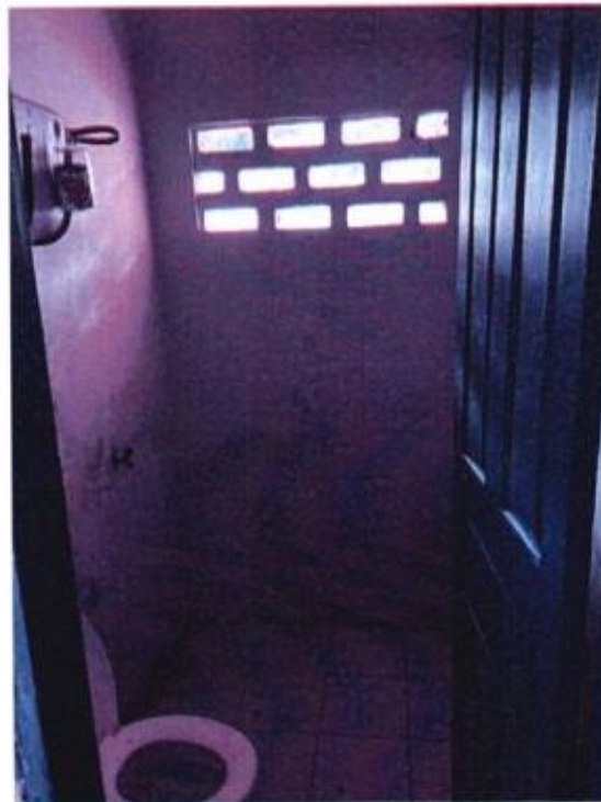
Imagem 15 – Piso danificado no banheiro
