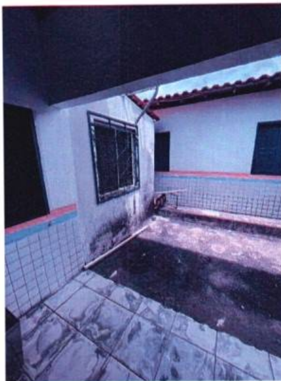
Imagem 12 – Piso danificado no pátio
