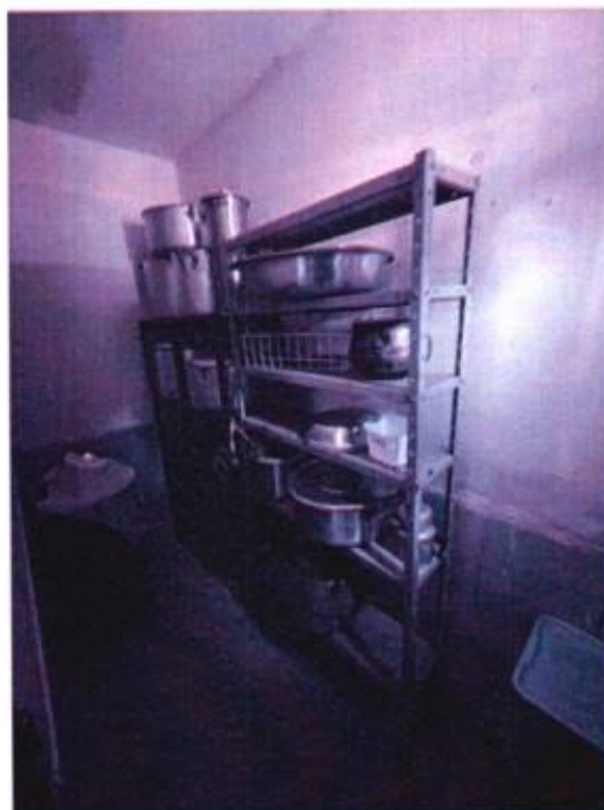
Imagem 13 – Pintura danificado no depósito da cozinha
