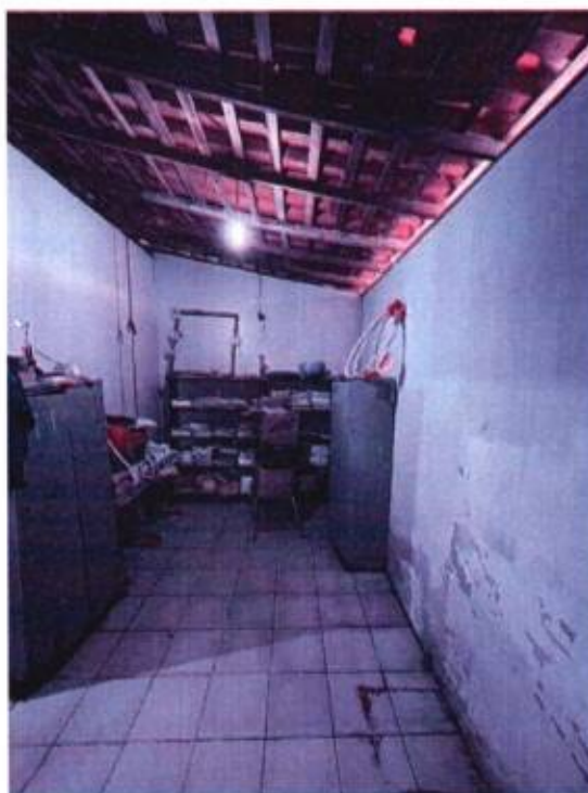
Imagem 9 – Pintura danificada no depósito
