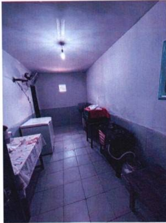
Imagem 14 – Pintura danificada na cozinha
