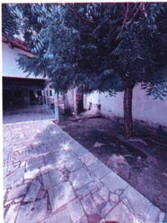
Imagem 19 – Piso danificado na entrada
