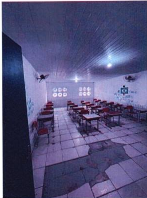
Imagem 10 – Piso danificado na sala
