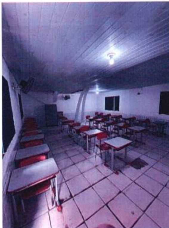
Imagem 8 – Forro danificado na sala
