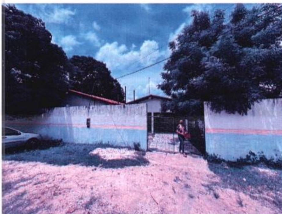
Imagem 1 – Pintura da fachada danificada
