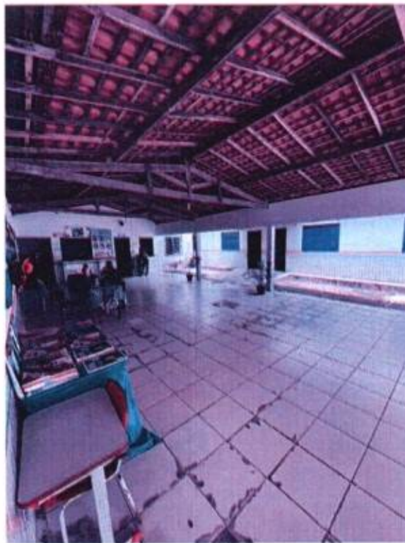
Imagem 5 – Piso danificado do pátio
