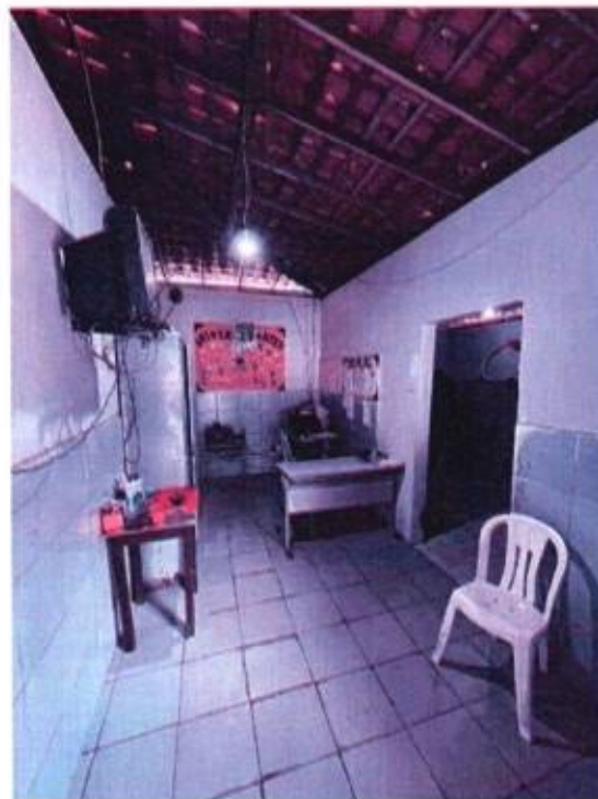
Imagem 11 – Piso danificado na sala dos professores
