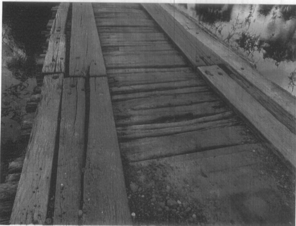
Imagem 03 – ponte de madeira com desgaste por falta de manutenção na passa roda, transversinas, pilares.
