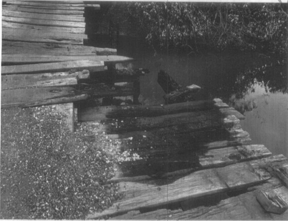
Imagem 04 – pilares, transversinas e pranchas queimados.
