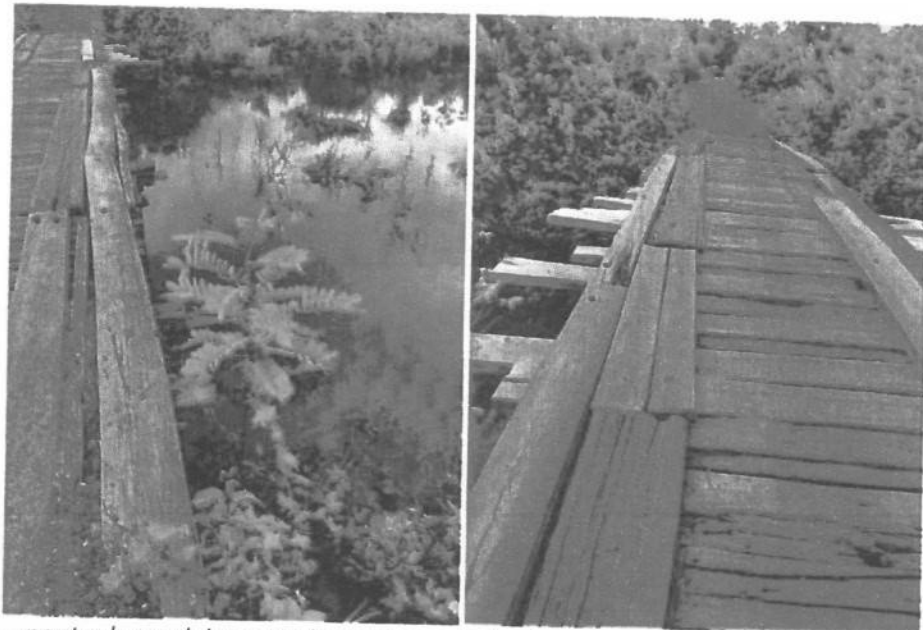
Imagem 02 – ponte de madeira com desgaste por falta de manutenção na passa roda, transversinas, pilares.
