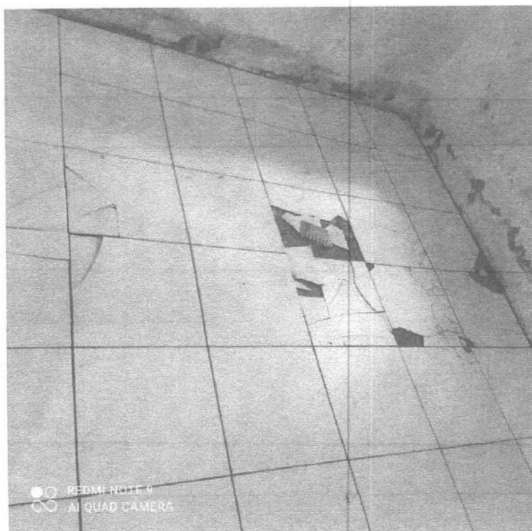
Figura 06: manchas nas paredes e bolhas na tinta, descolamento de revestimento cerâmico.
