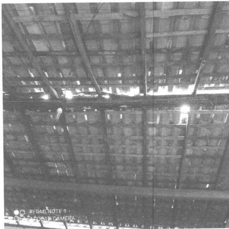
Figura 03: Telhado deteriorado sem manutenção
