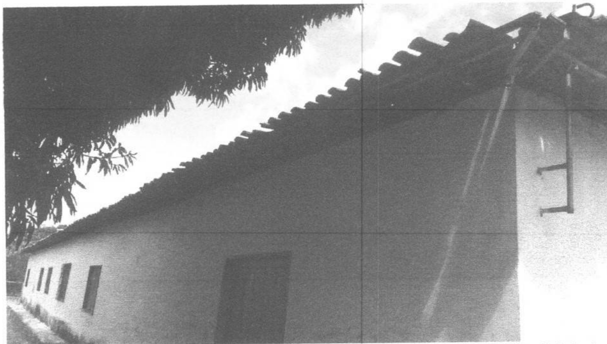
Figura 02: fachada lateral da unidade escolar - avaria na impermeabilidade da superfície da fachada decorrente da perda do desempenho da pintura.
