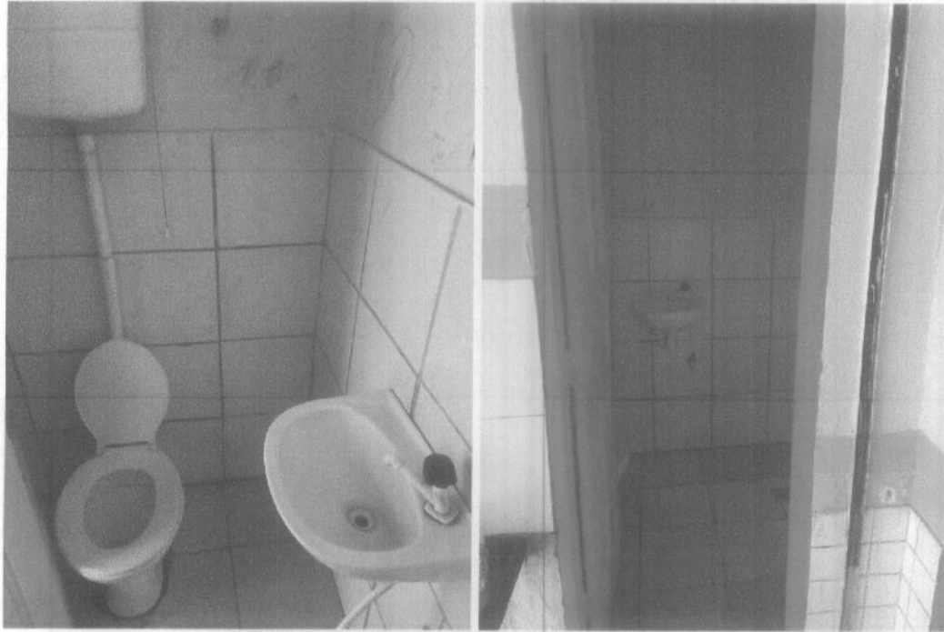
Figura 07: banheiro da U.E Bernarda Portela da Ponte.
