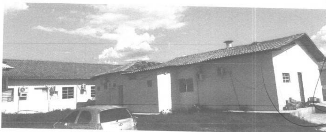
Imagem 8 – Necessidade de manutenção na cobertura – Fundo.
