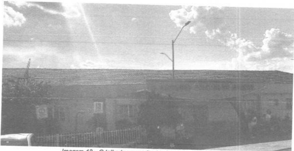
Imagem 13 – O telhado necessita de alteração – Frente.
