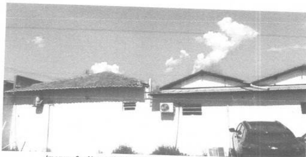
Imagem 6 – Necessário fazer reparo na cobertura – Fundo.
