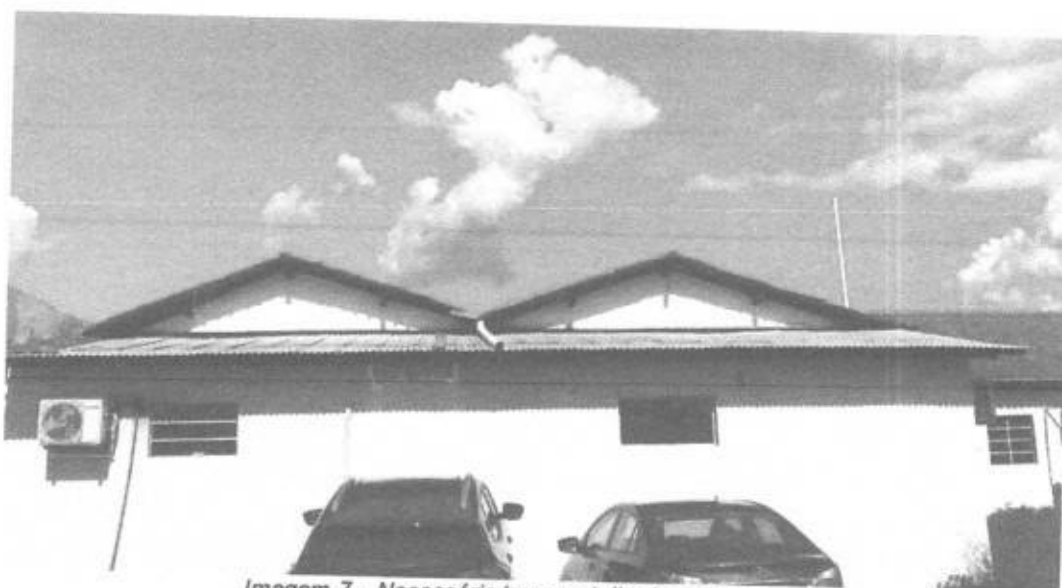
Imagem 7 – Necessário trocar o telhado – Fundo.
