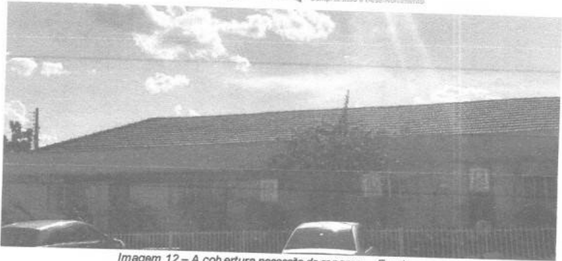
Imagem 12 – A cobertura necessita de reparos – Frente.
