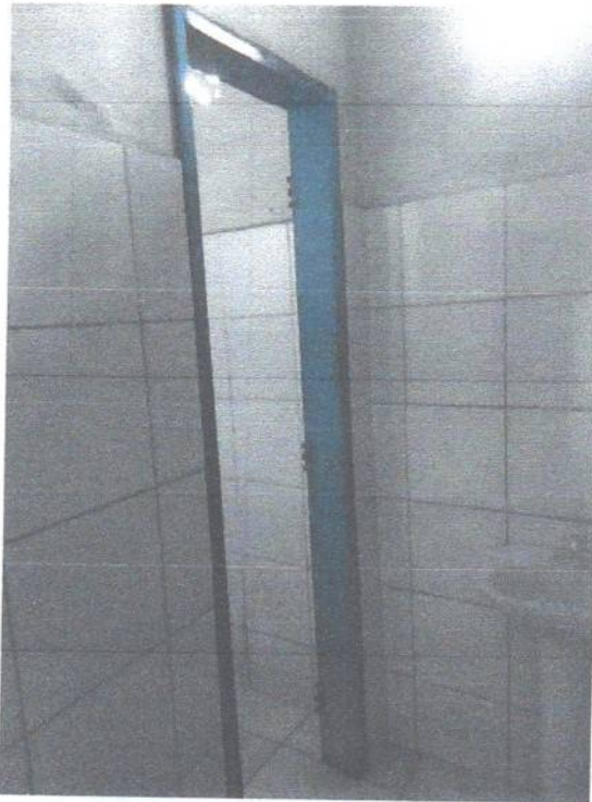
Imagem 27– Banheiro feminino sem porta
