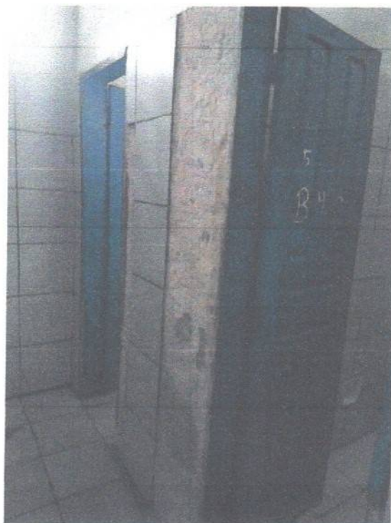
Imagem 21– Banheiro com deslocamento
