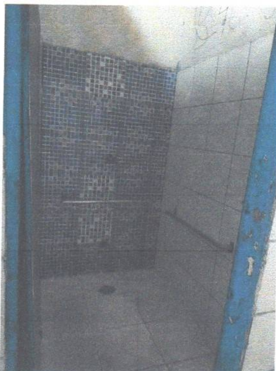
Imagem 20–Banheiro pcd masculino sem bacia sanitária e pia
