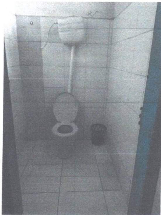
Imagem 25- Banheiro feminino sem porta
