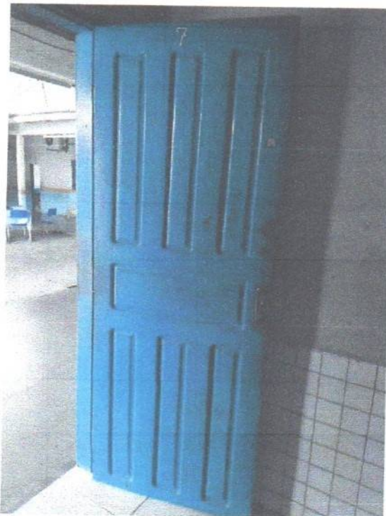
Imagem 30– Porta sem fechadura
