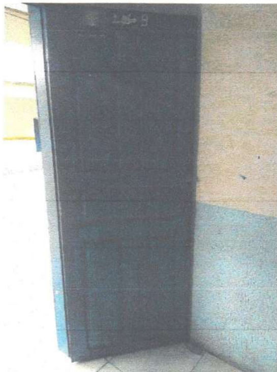
Imagem 29- Porta sem fechadura
