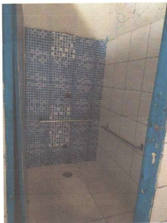
Imagem 20-Banheiro pcd masculino sem bacia sanitária e pia
