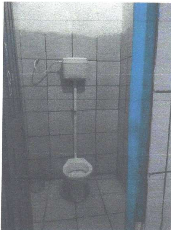
Imagem 23- Banheiro dos Professores
