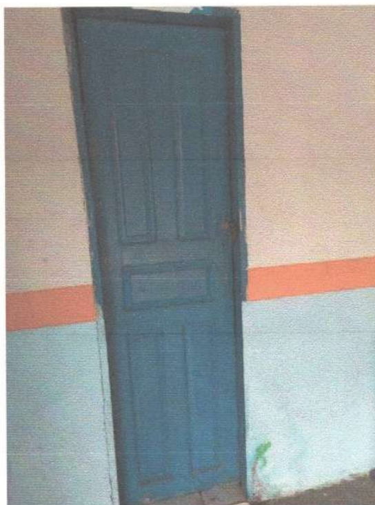
Imagem 28– Porta sem fechadura
