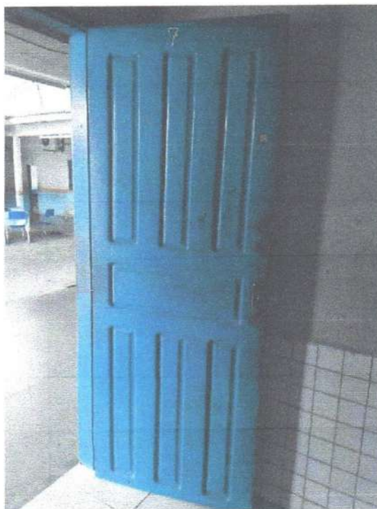
Imagem 30- Porta sem fechadura
