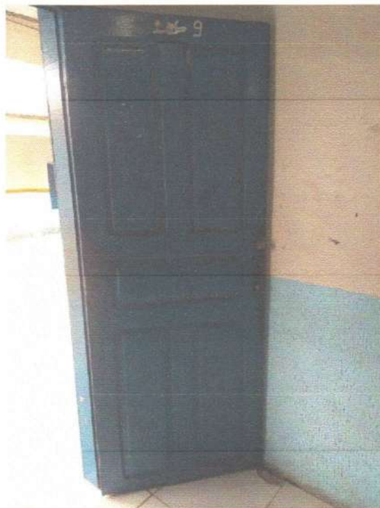
Imagem 29- Porta sem fechadura
