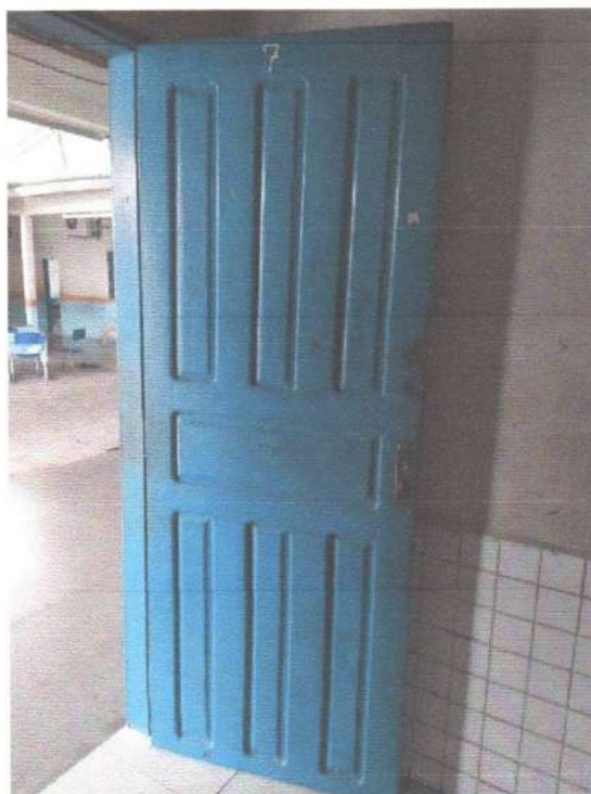
Imagem 30- Porta sem fechadura
