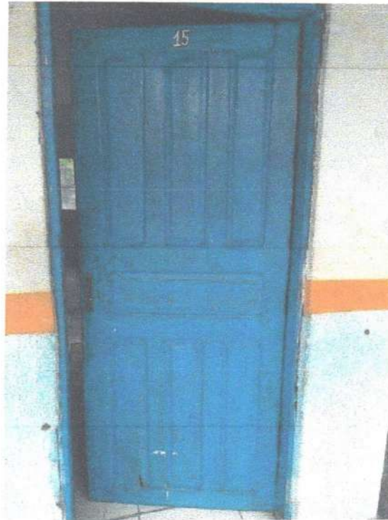
Imagem 31- Porta sem fechadura
