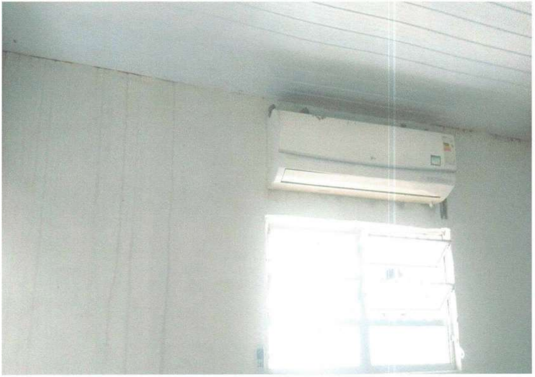
imagem 6 - Pintura interna danificada
