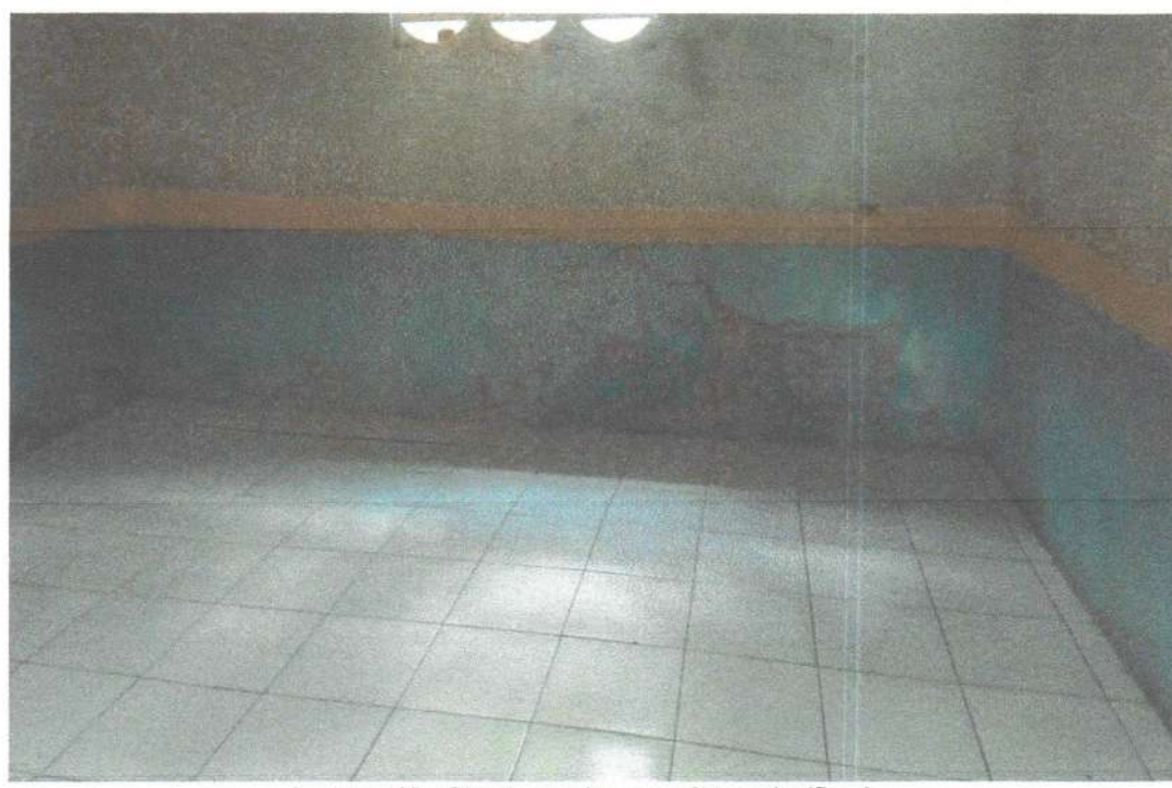
imagem 10 - Chapisco, reboco, e pintura danificados
