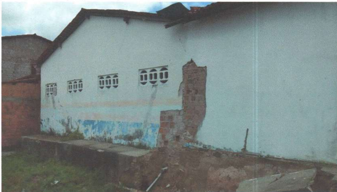
imagem 2 - Chapisco, reboco, pintura, e calçada danificados; rachadura em paredes
