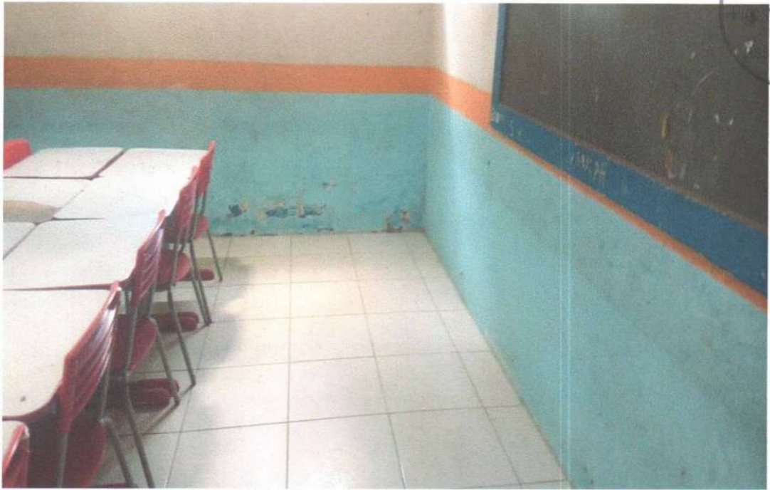
imagem 13 - Chapisco, reboco, e pintura danificados
