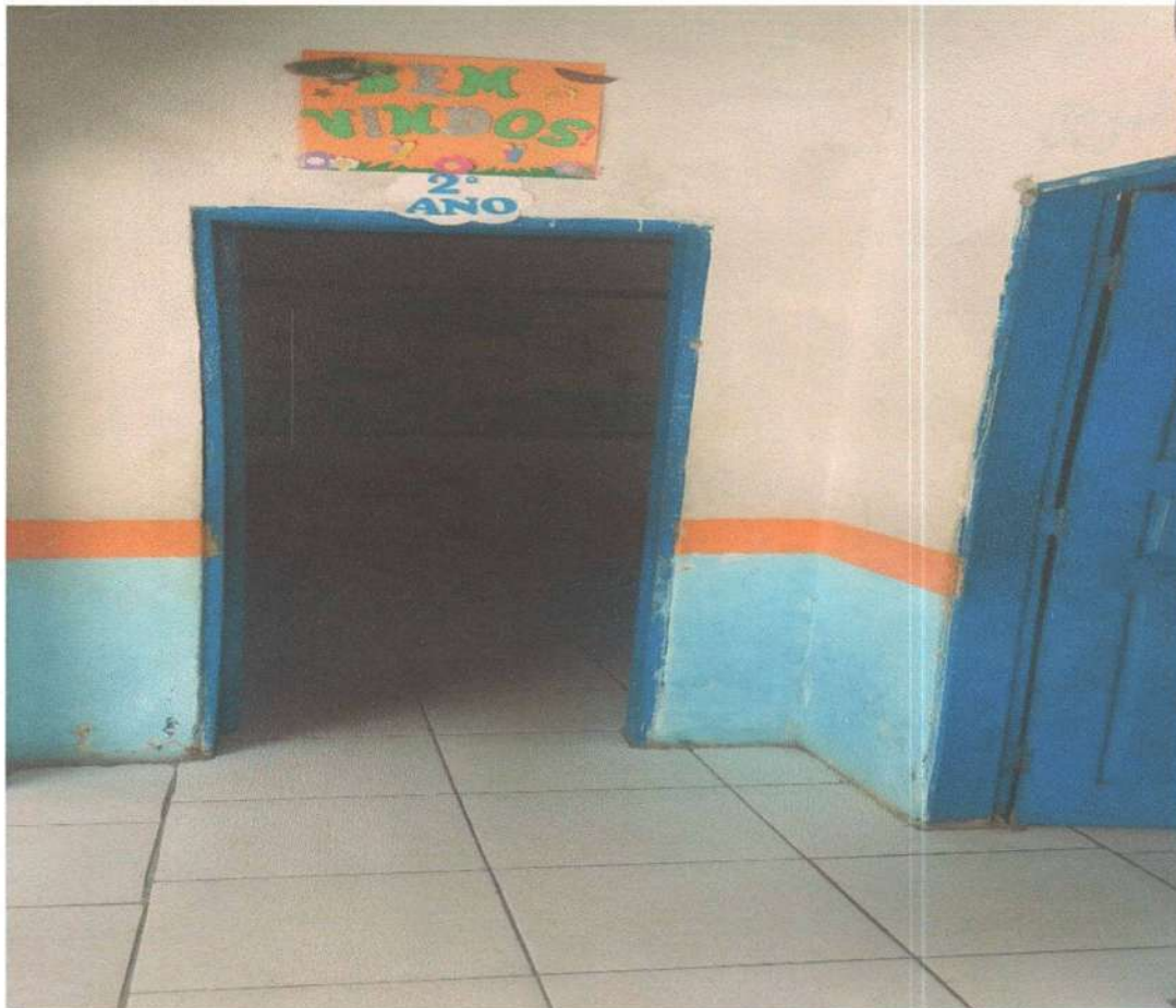
imagem 21 – Pintua interna danificada
