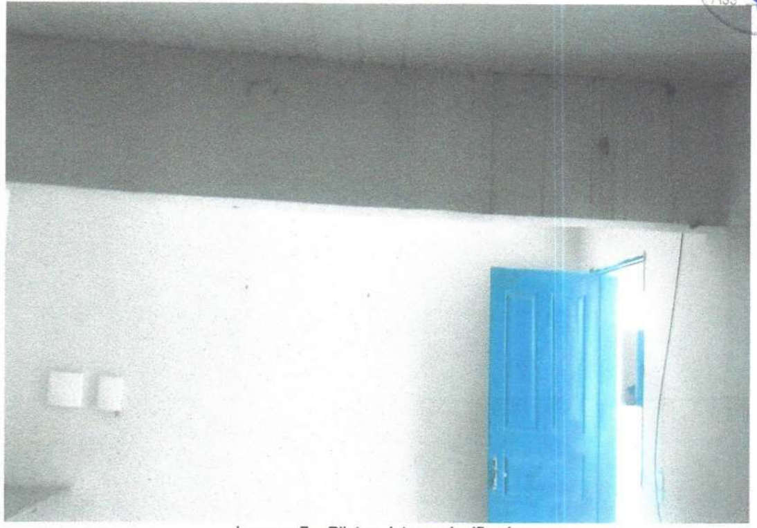
imagem 7 - Pintura interna danificada
