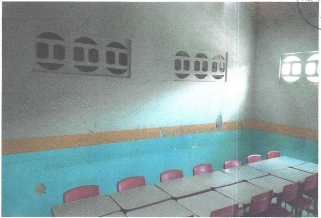
imagem 11 - Chapisco, reboco, e pintura danificados
