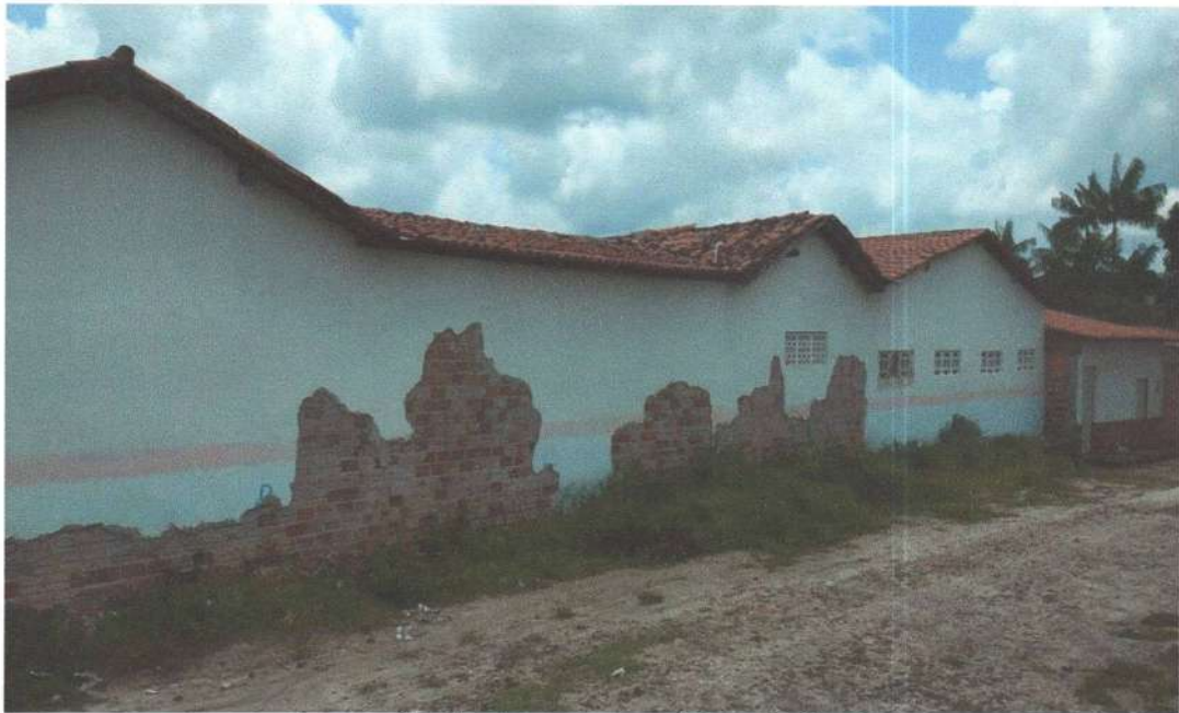
imagem 1 - Chapisco, reboco, e pintura danificados
