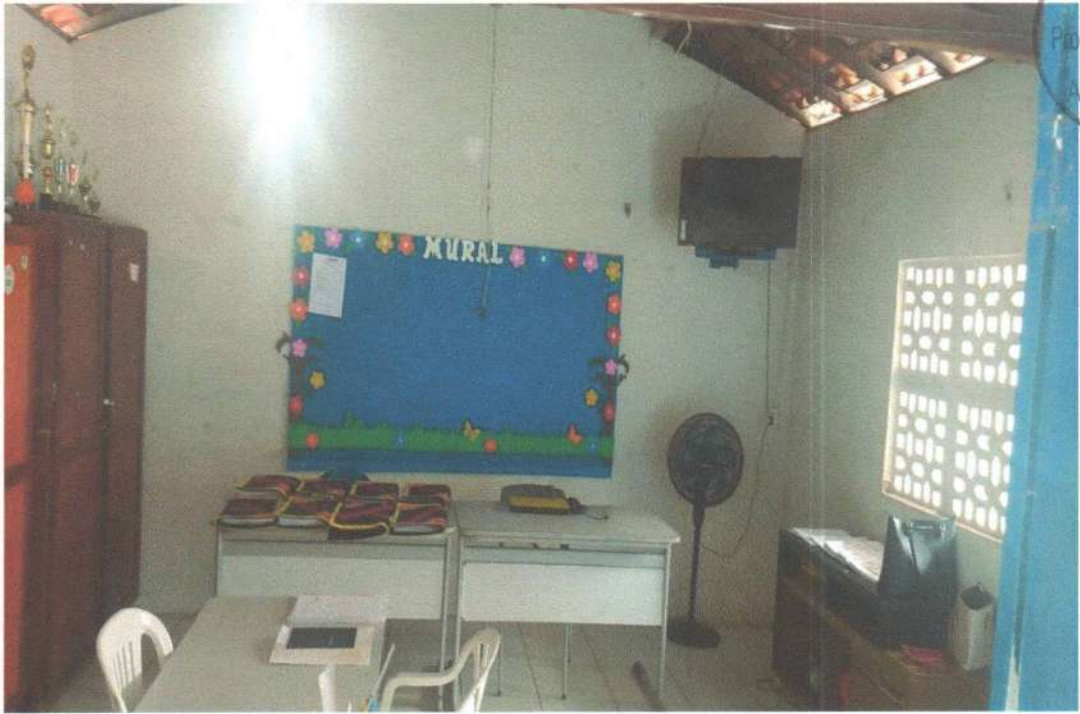
imagem 17 - Pintura interna danificada
