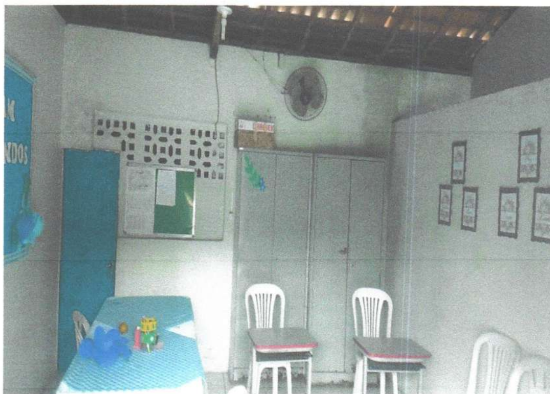
imagem 18 - Pintura interna danificada
