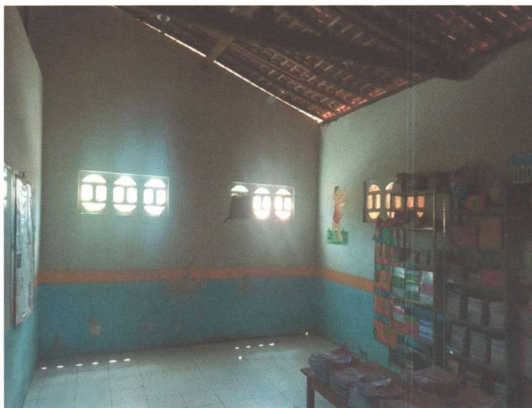
imagem 20 - Chapisco, reboco, e pintura danificados
