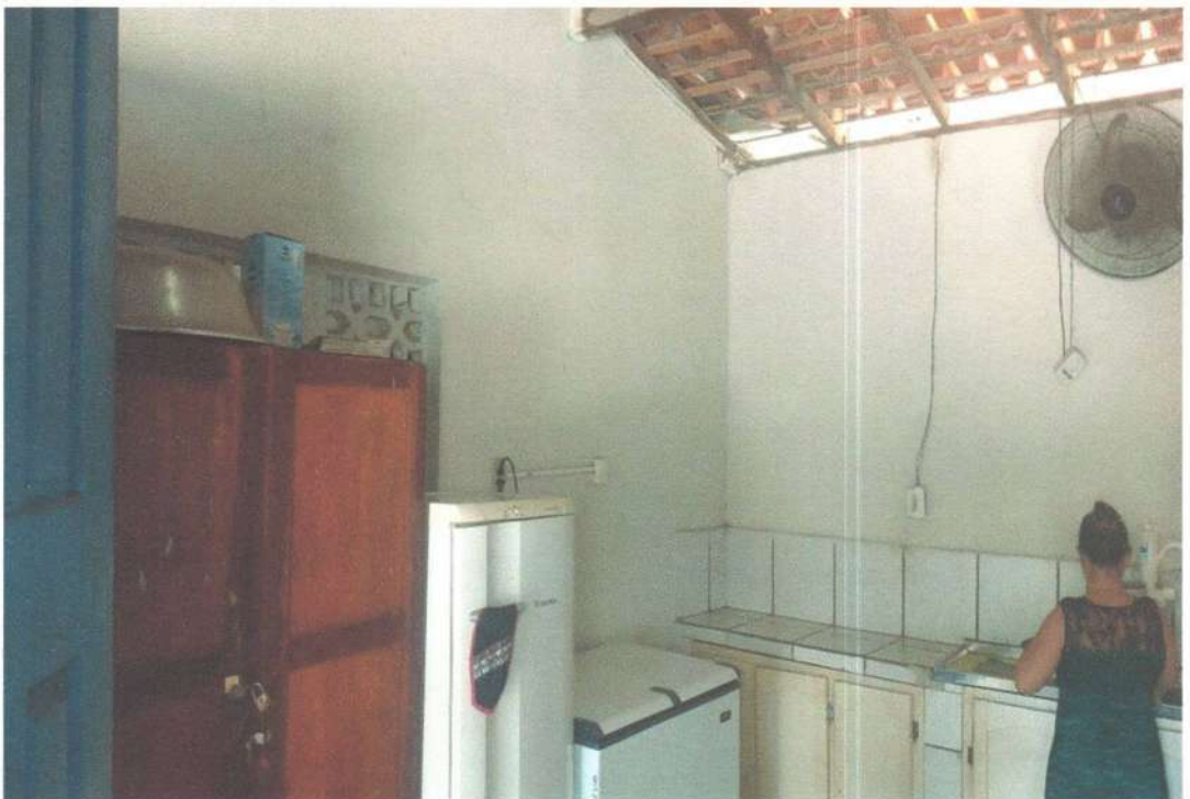
imagem 12 - Pintura interna danificada
