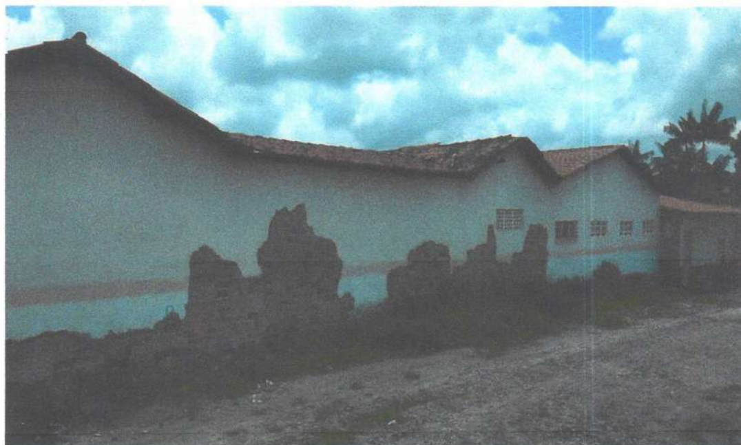
imagem 1 - Chapisco, reboco, e pintura danificados
