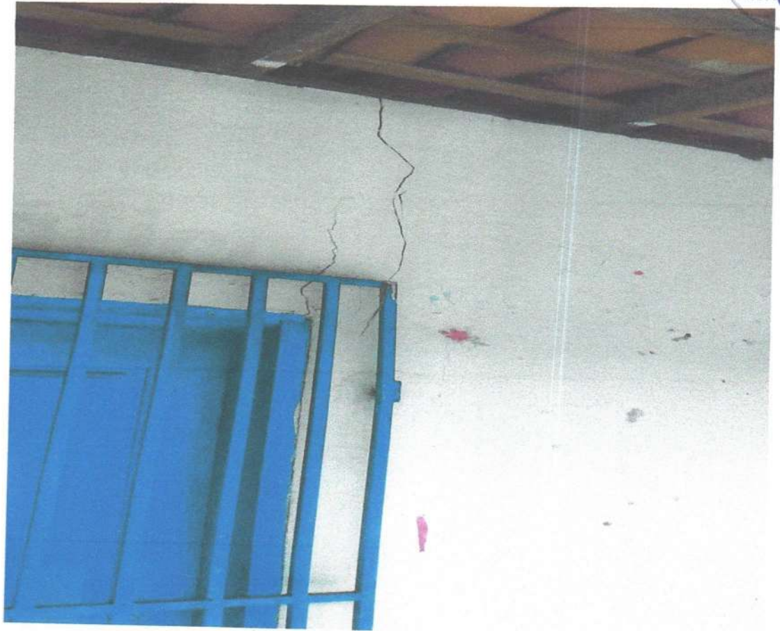
imagem 37 - Rachadura na parede
