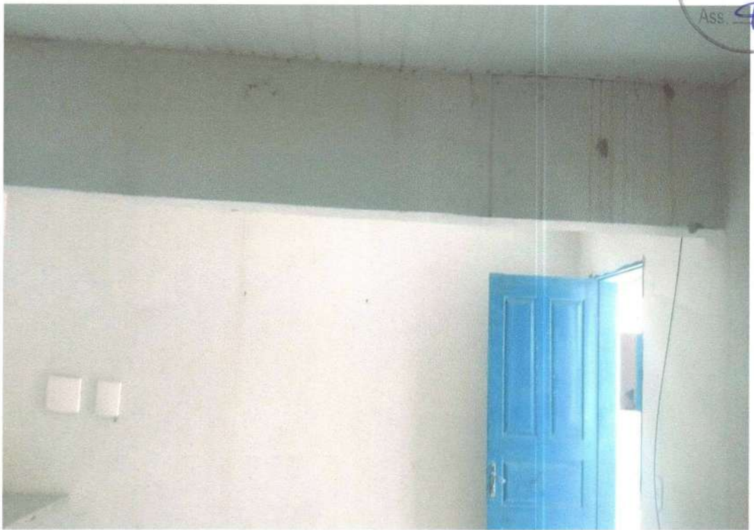
imagem 7 - Pintura interna danificada
