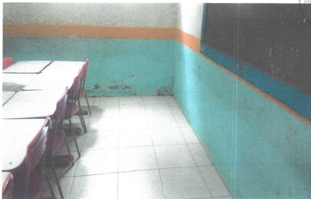
imagem 13 - Chapisco, reboco, e pintura danificados
