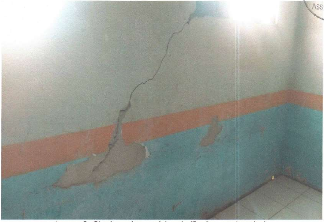
imagem 5 - Chapisco, reboco, e pintura danificados; parede rachada
