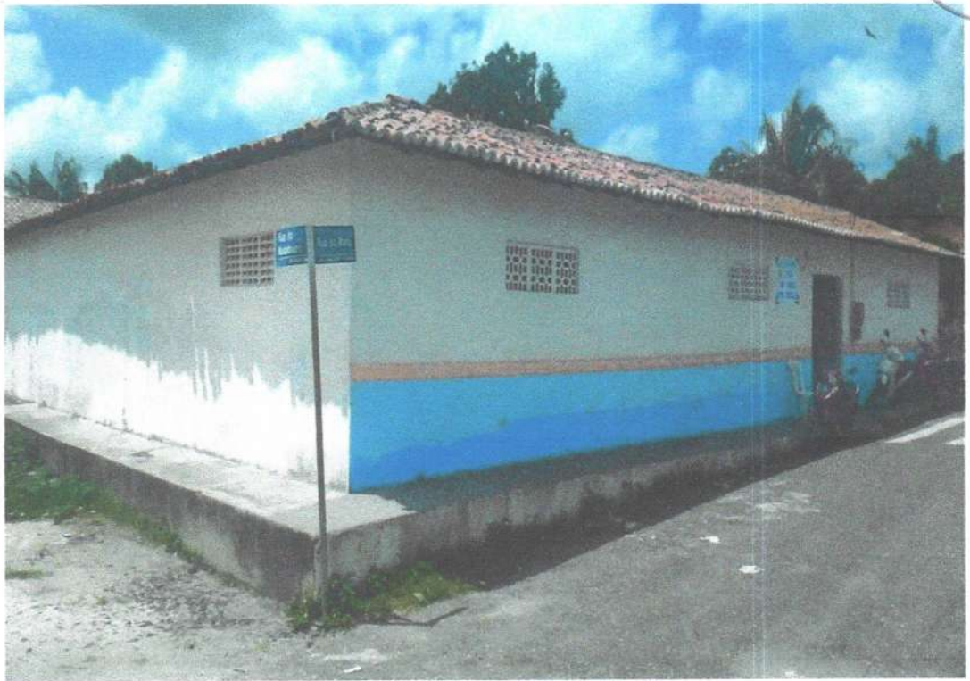
imagem 3 - Pintura externa danificada
