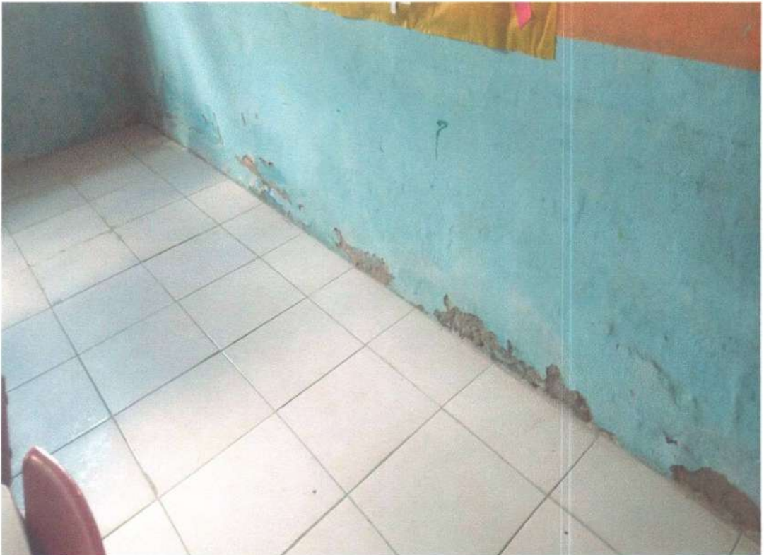
imagem 16 - Chapisco, reboco, e pintura danificados
