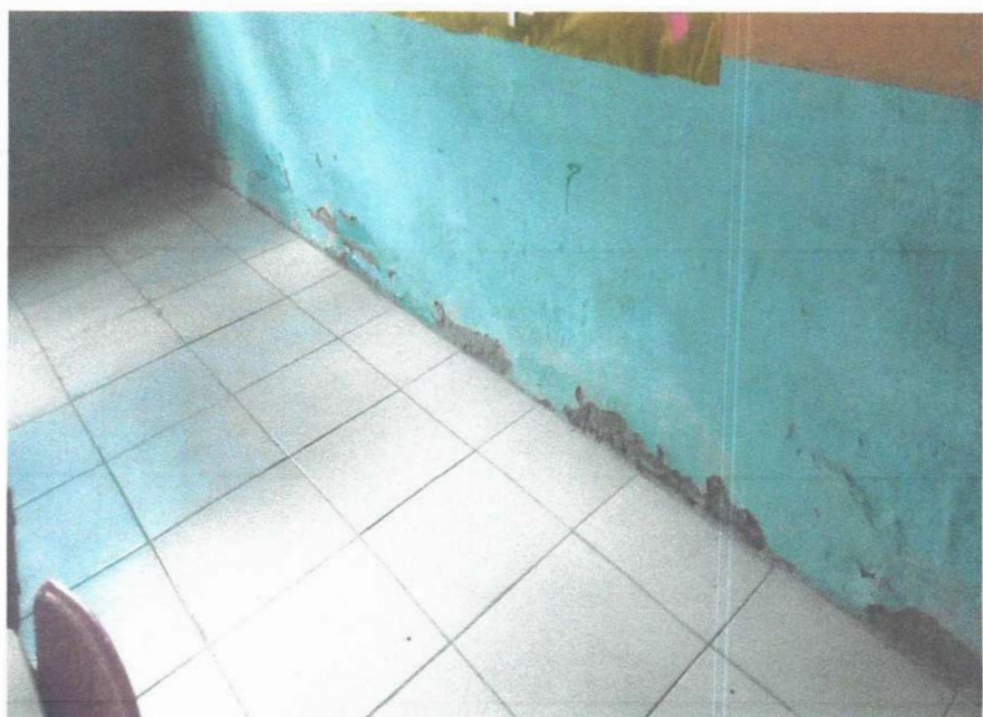
imagem 16 - Chapisco, reboco, e pintura danificados
