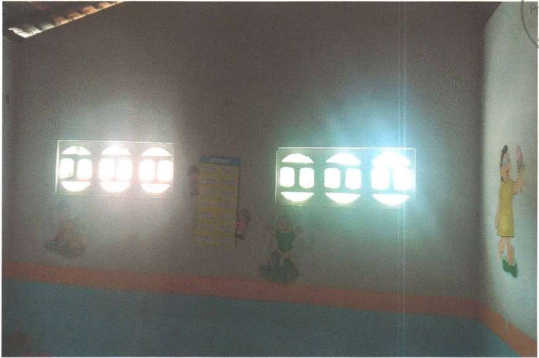
imagem 15 – Pintura interna danificada
