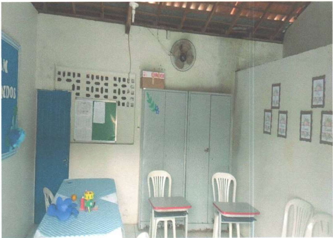
imagem 18 - Pintura interna danificada
