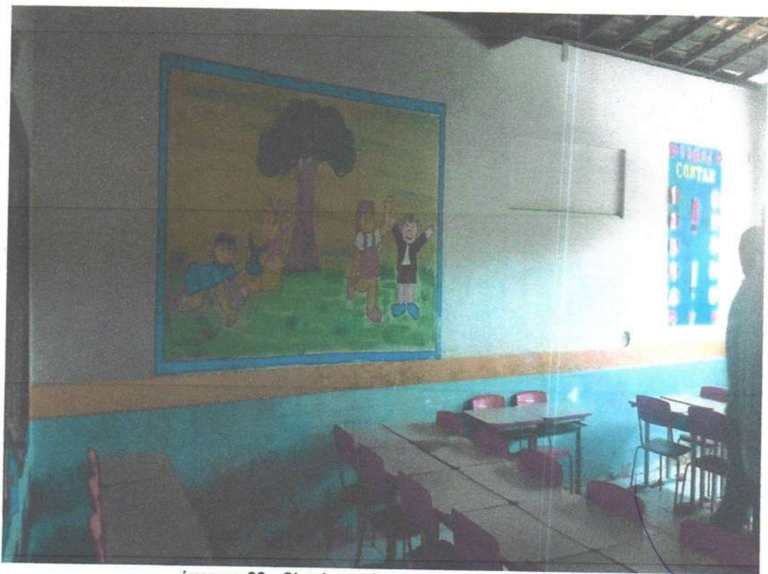
imagem 22 - Chapisco, reboco, e pintura danificados
