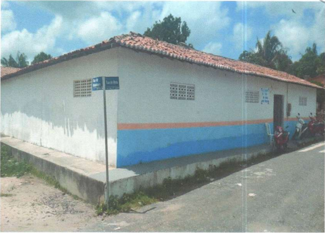
imagem 3 - Pintura externa danificada
