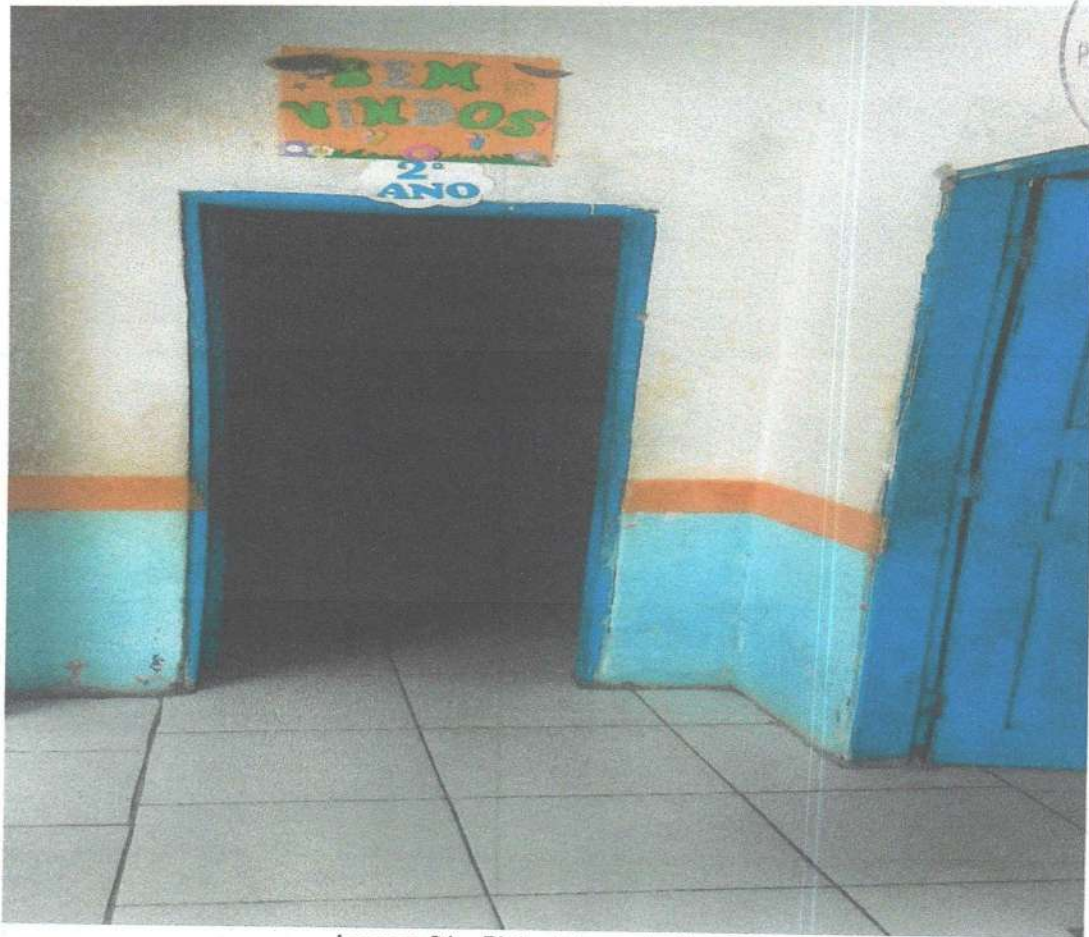
imagem 21 – Pintua interna danificada
