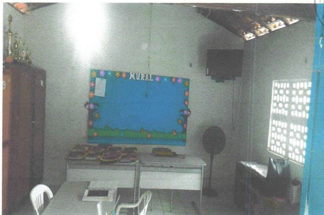
imagem 17 - Pintura interna danificada
