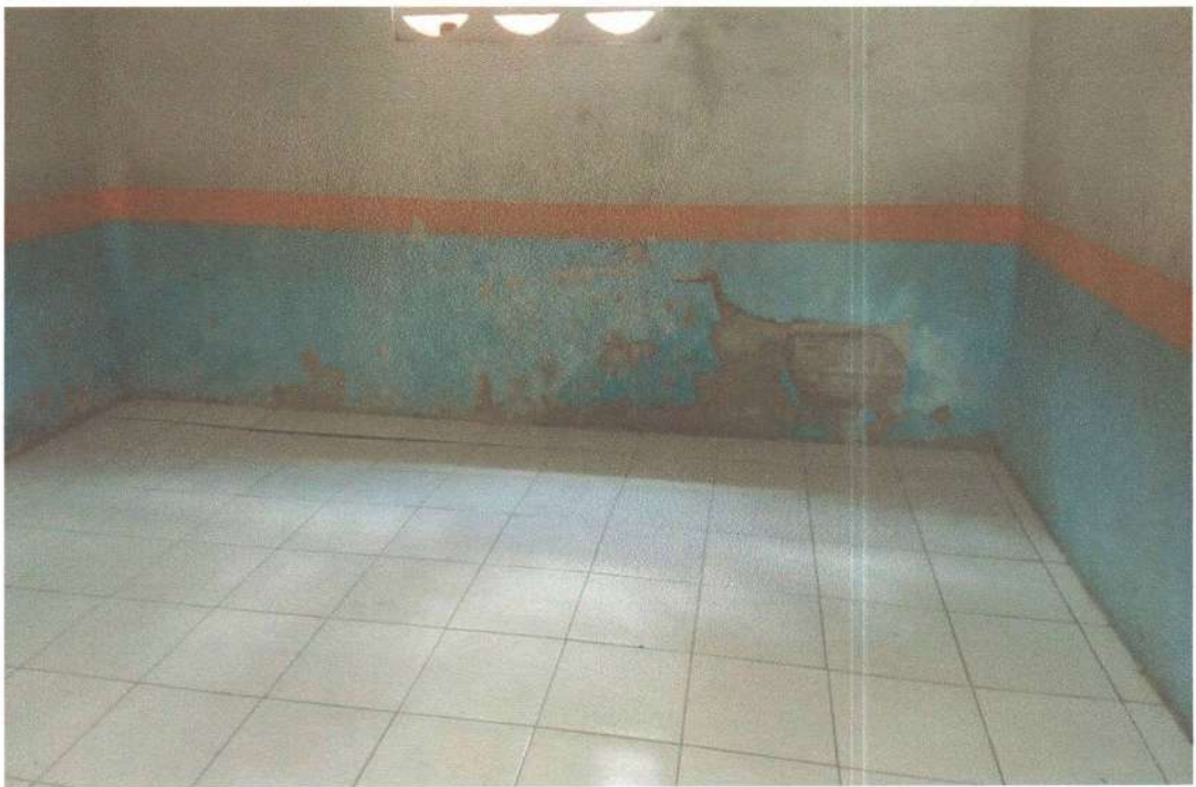
imagem 10 - Chapisco, reboco, e pintura danificados
