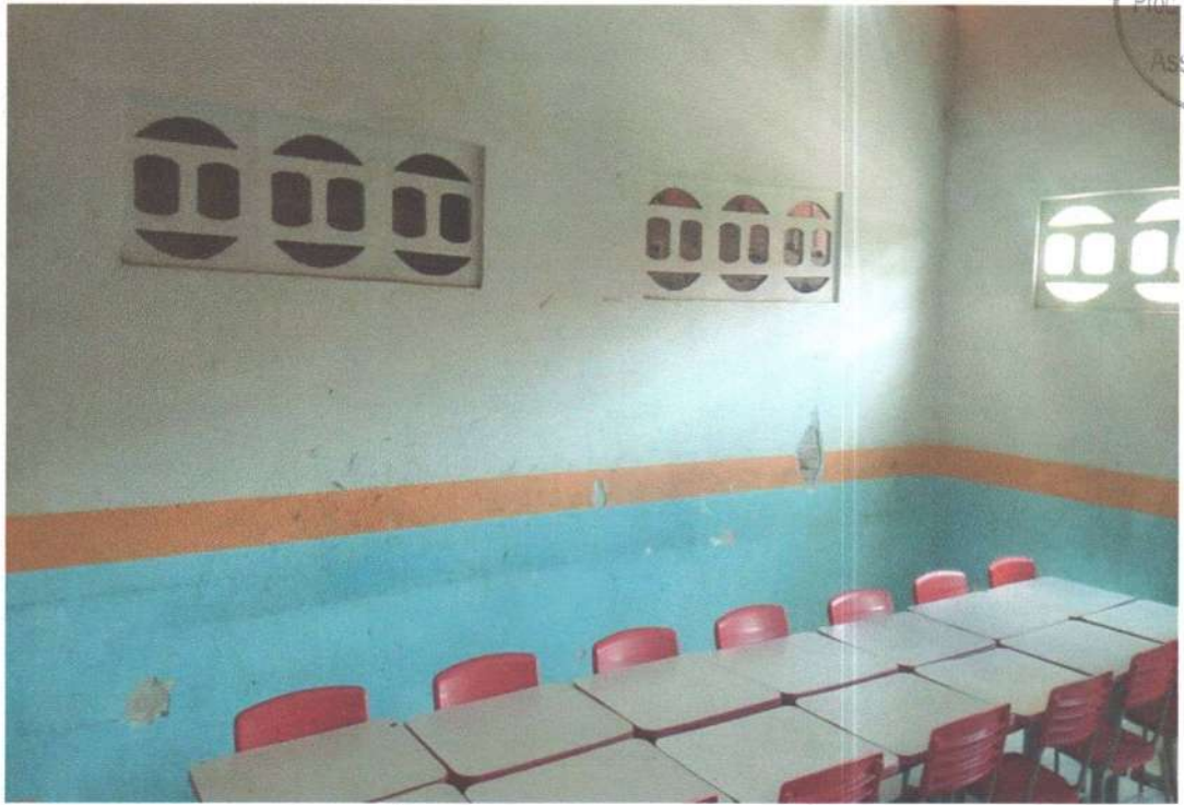
imagem 11 - Chapisco, reboco, e pintura danificados
