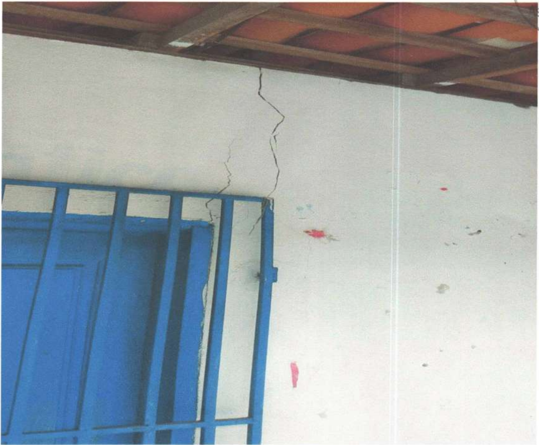
imagem 37 - Rachadura na parede
