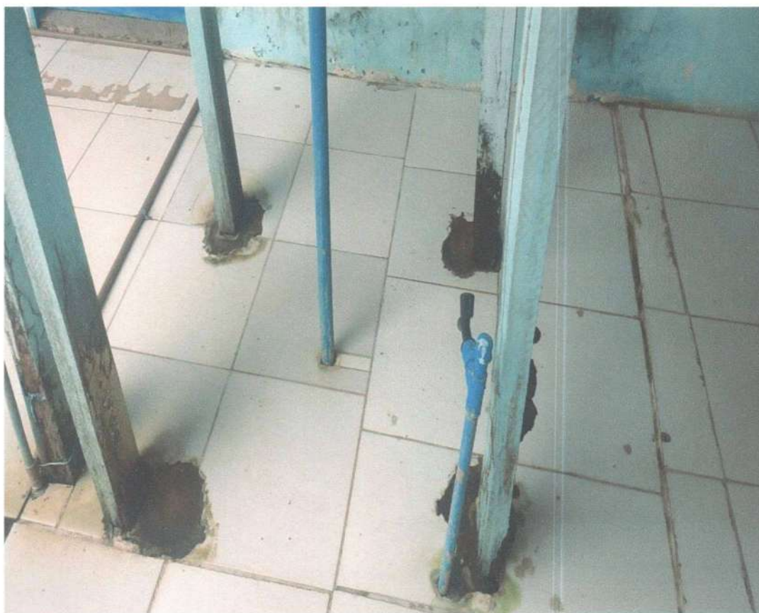
imagem 36 - Pilares de madeira deteriorados
