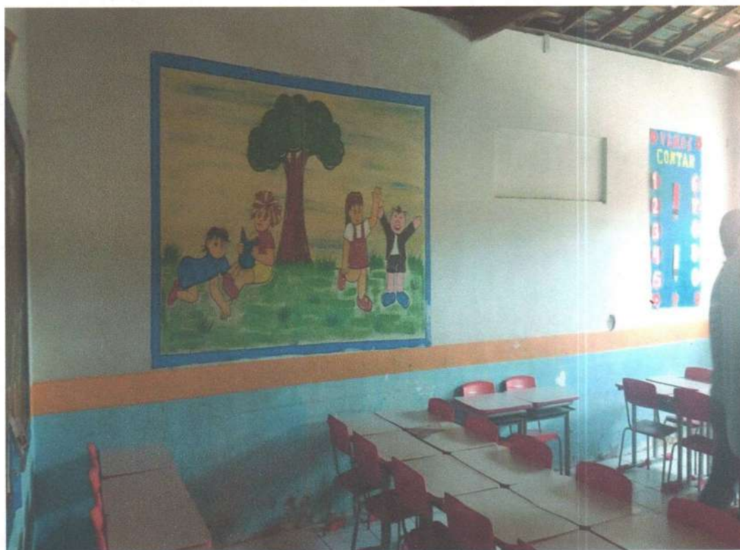
imagem 22 - Chapisco, reboco, e pintura danificados
