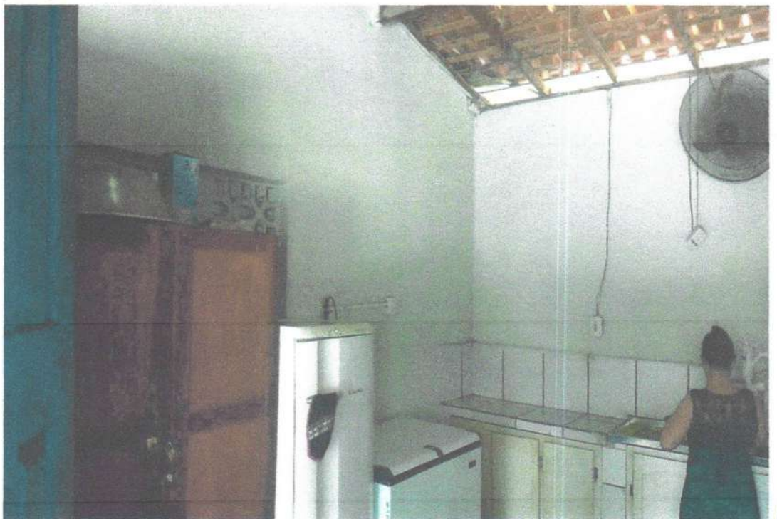
imagem 12 - Pintura interna danificada
