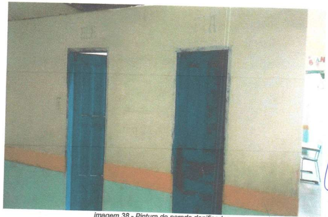
imagem 38 - Pintura de parede danificadas
