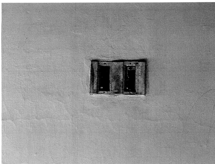
Imagem 24 – Quadro de distribuição danificado
