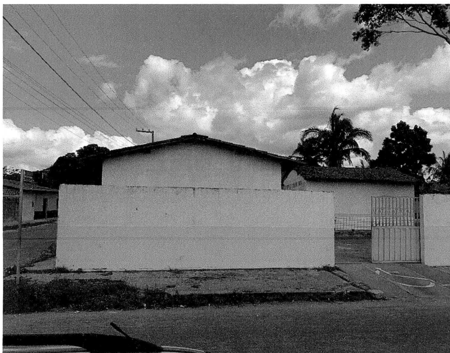
Imagem 1 – Pintura fachada da escola danificada
