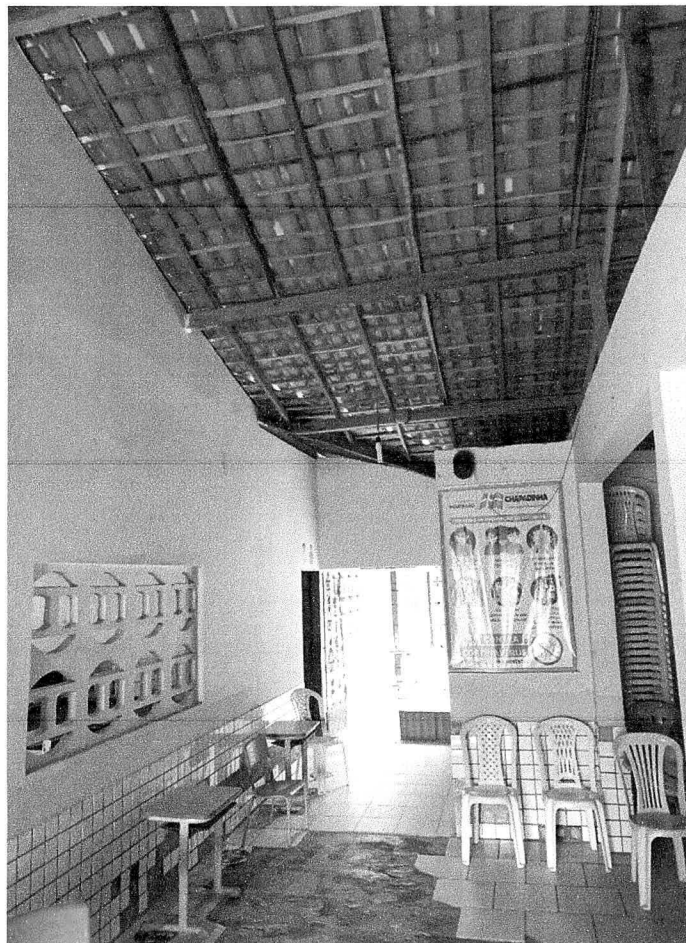
Imagem 9 – Pintura e pavimento danificado
