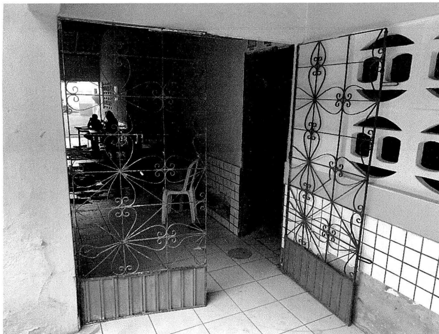
Imagem 26 – Pintura, revestimento e esquadrias danificados
