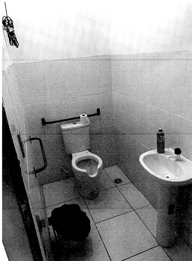
Imagem 29 – Banheiro PCD fora das dimensões mínimas
