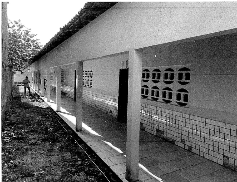
Imagem 25 – Pintura e piso danificados
