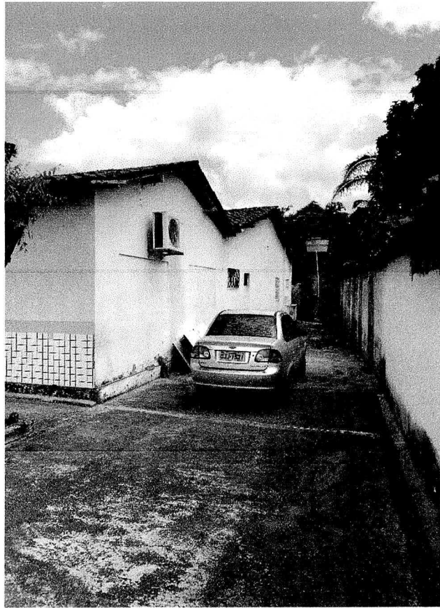
Imagem 7 – Externa da escola com pintura danificada
