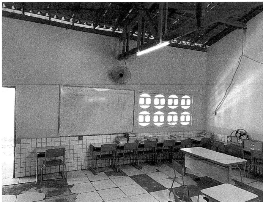
Imagem 21 – Pintura interna e piso danificados
