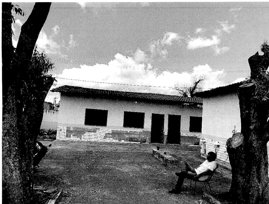
Imagem 8 – Externa da escola com revestimento e pintura danificada
