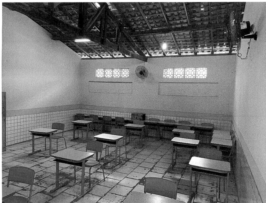
Imagem 22 – Pintura interna e piso danificados
