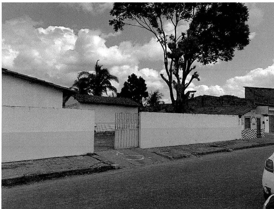
Imagem 2 – Pintura fachada da escola danificada
