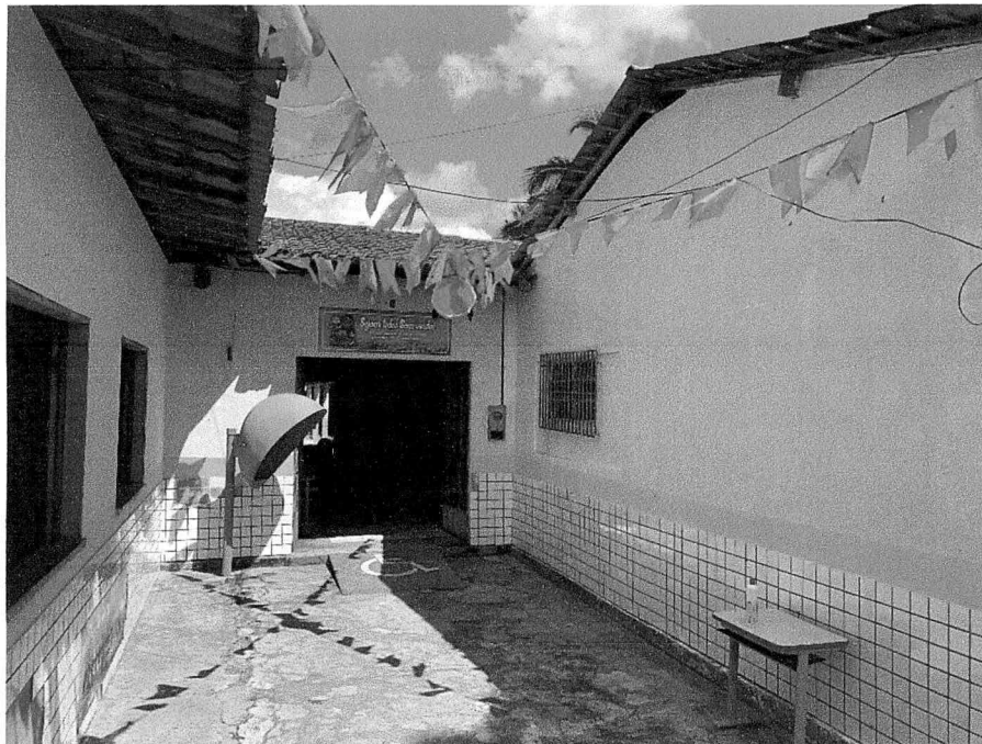
Imagem 6 – Entrada da escola com pintura danificada
