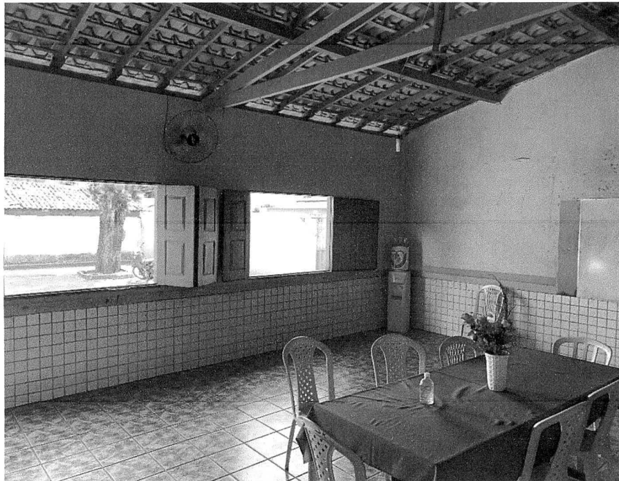
Imagem 5 – Esquadrias e pintura danificada
