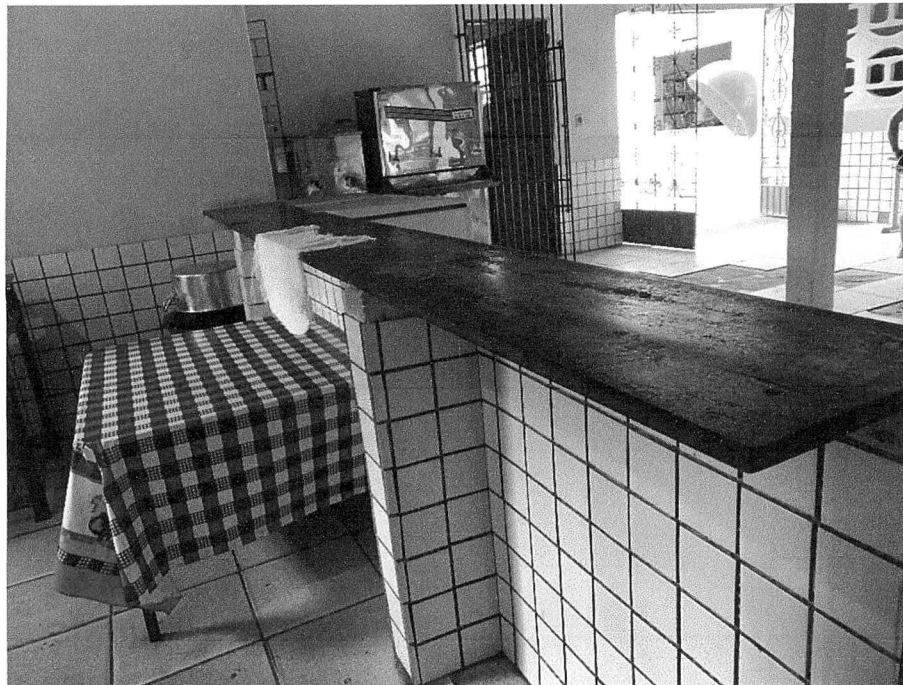
Imagem 16 – Pintura e balcão da cozinha danificados
