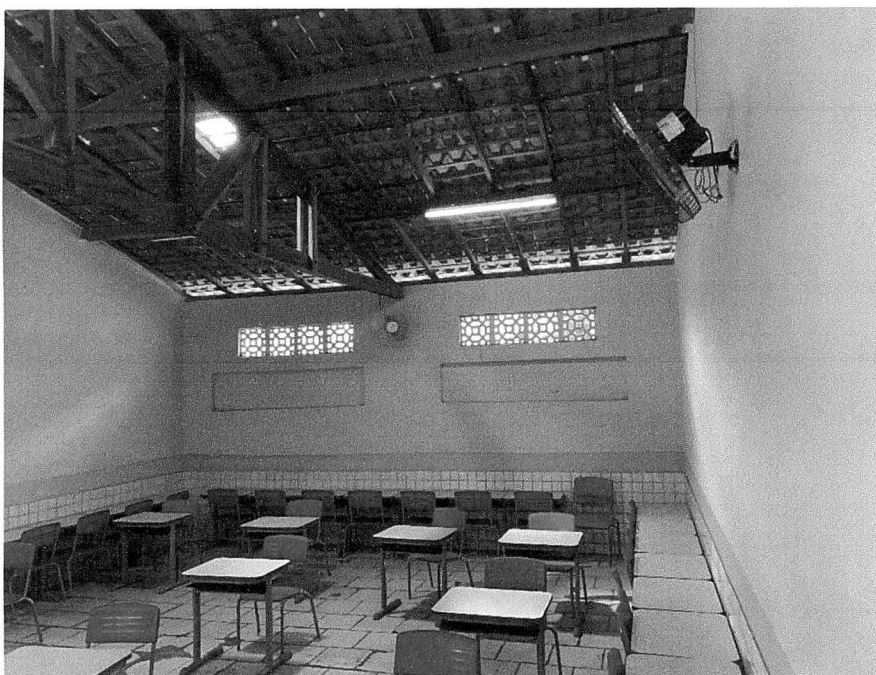
Imagem 18 – Pintura interna e piso danificados
