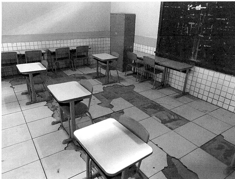
Imagem 20 – Pintura interna e piso danificados
