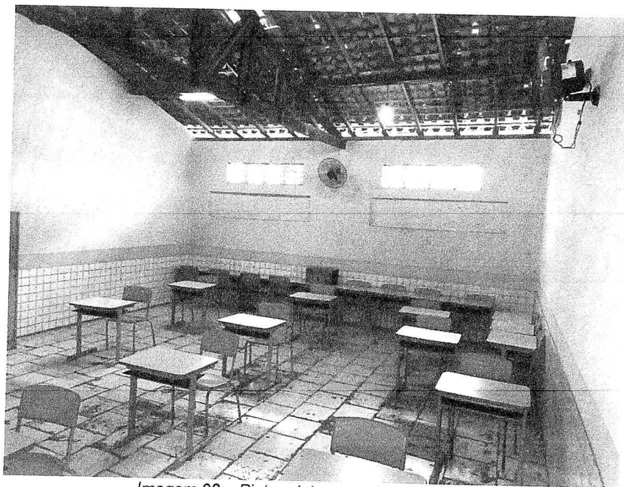
Imagem 22 – Pintura interna e piso danificados
