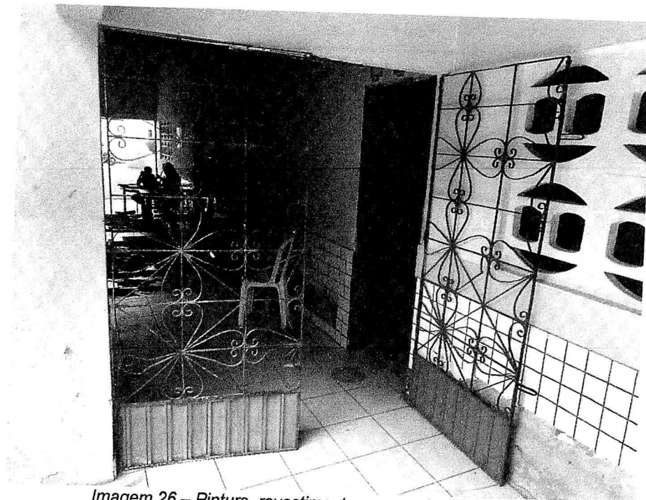
Imagem 26 – Pintura, revestimento e esquadrias danificados
