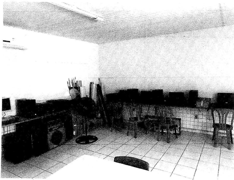
Imagem 12 – Pintura e dreno do ar-condicionado danificados
