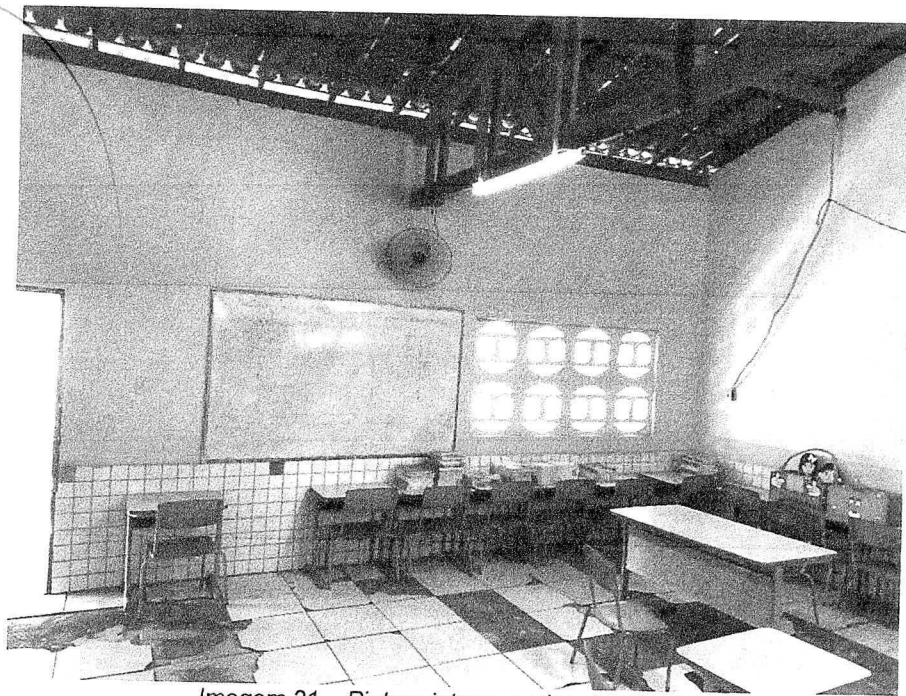
Imagem 21 – Pintura interna e piso danificados
