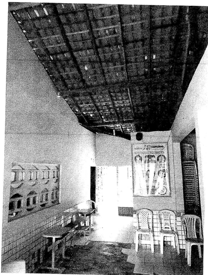
Imagem 9 – Pintura e pavimento danificado
