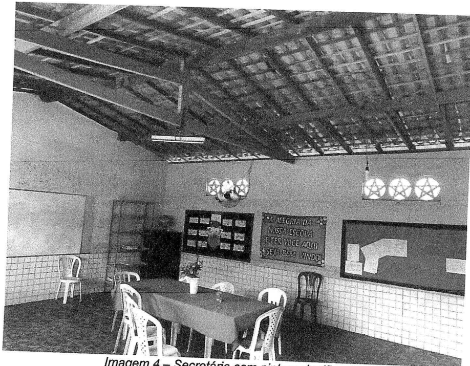
Imagem 4 – Secretária com pintura danificada
