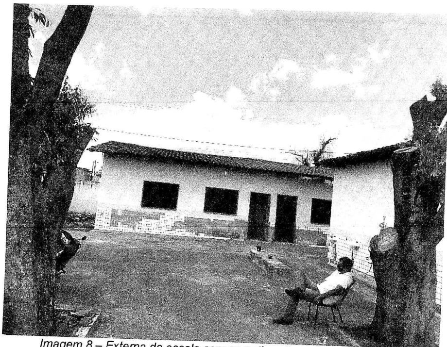
Imagem 8 – Externa da escola com revestimento e pintura danificada
