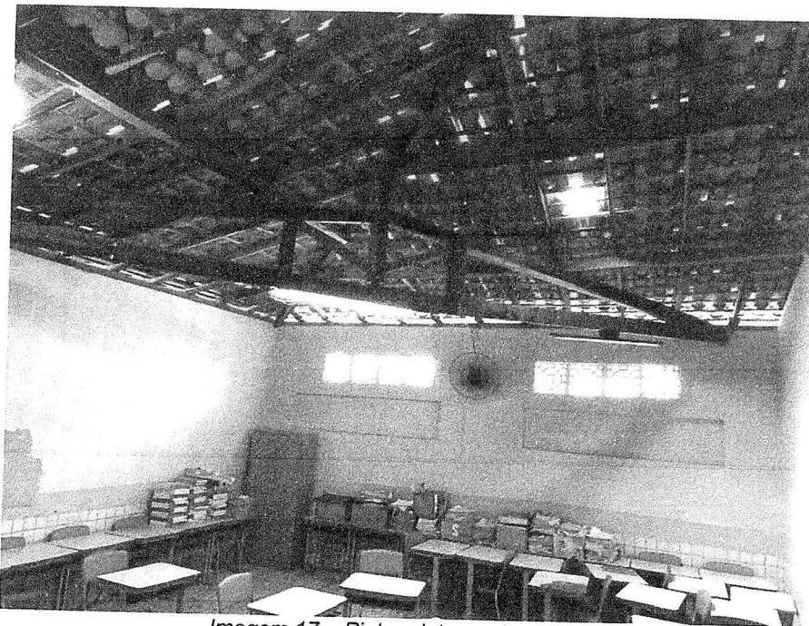
Imagem 17 – Pintura interna danificada
