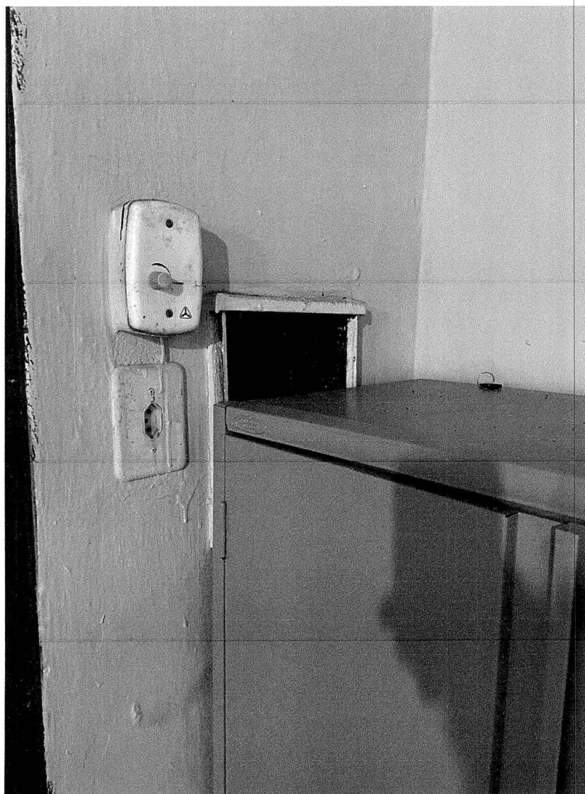
Imagem 28 – Instalações Elétricas Danificadas
