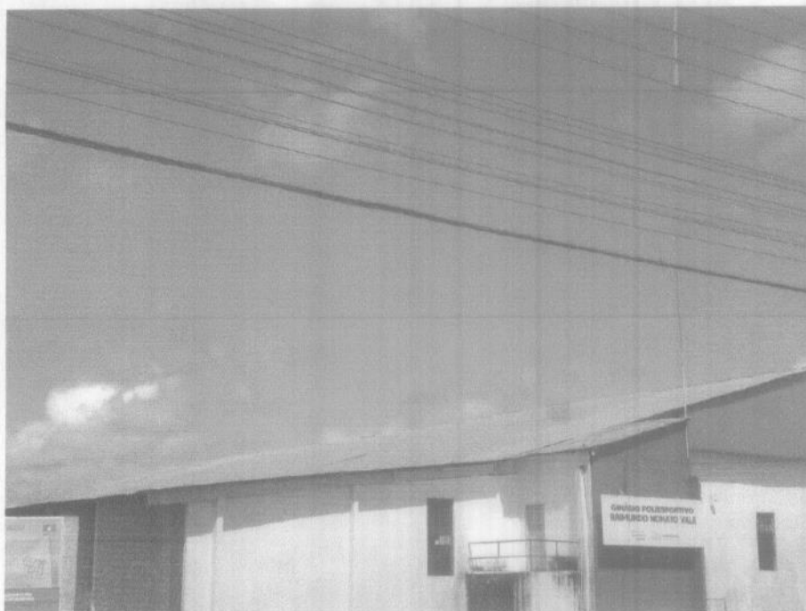
Imagem 12 – vista dos pontos de inclinação da cobertura metálica.
