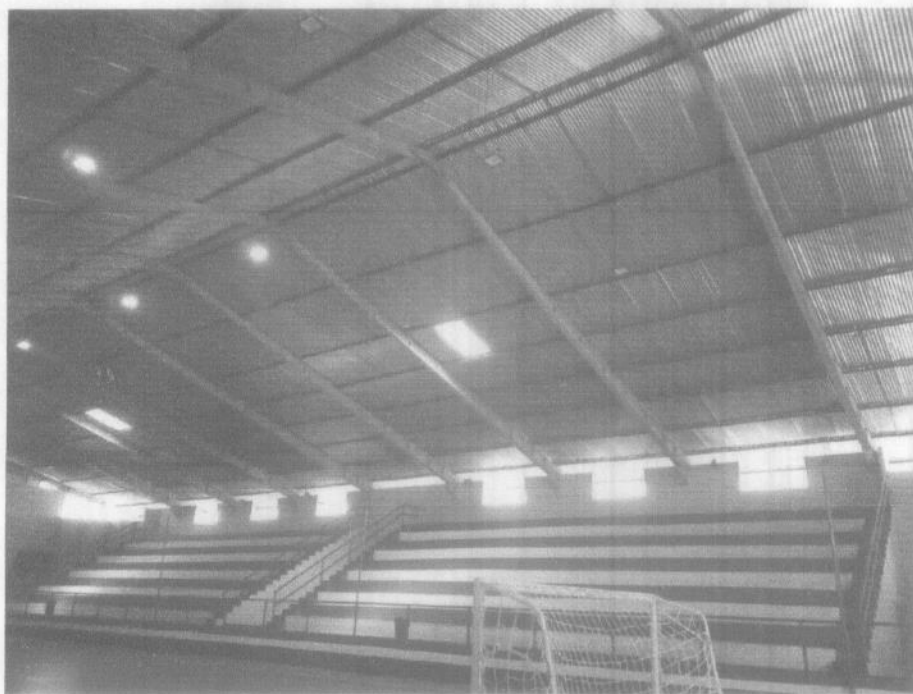
Imagem 04 – vista da arquibancada do ginásio, ponto de inclinação do lado direito da cobertura metálica.
