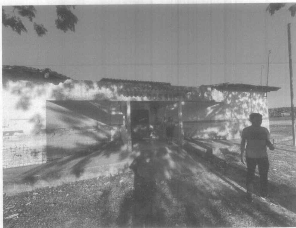
imagem 1 – Pintura da Fachada danificada
