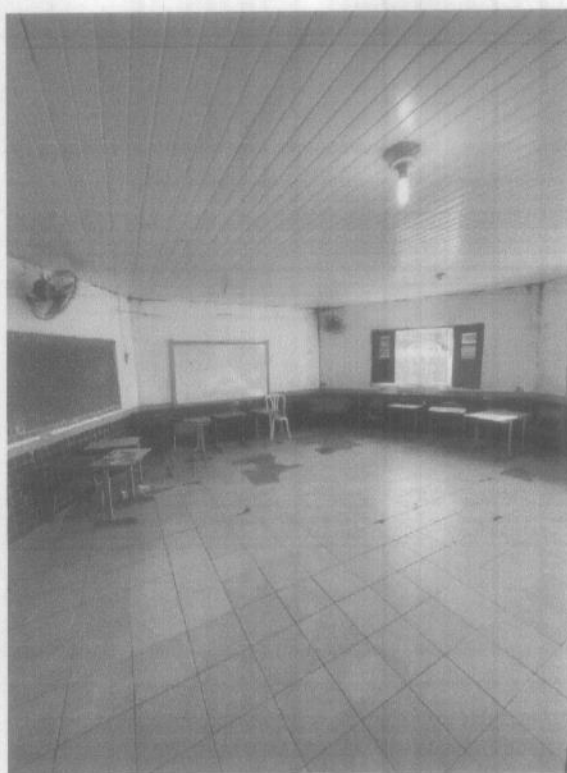
imagem 5 – Piso danificado nas salas
