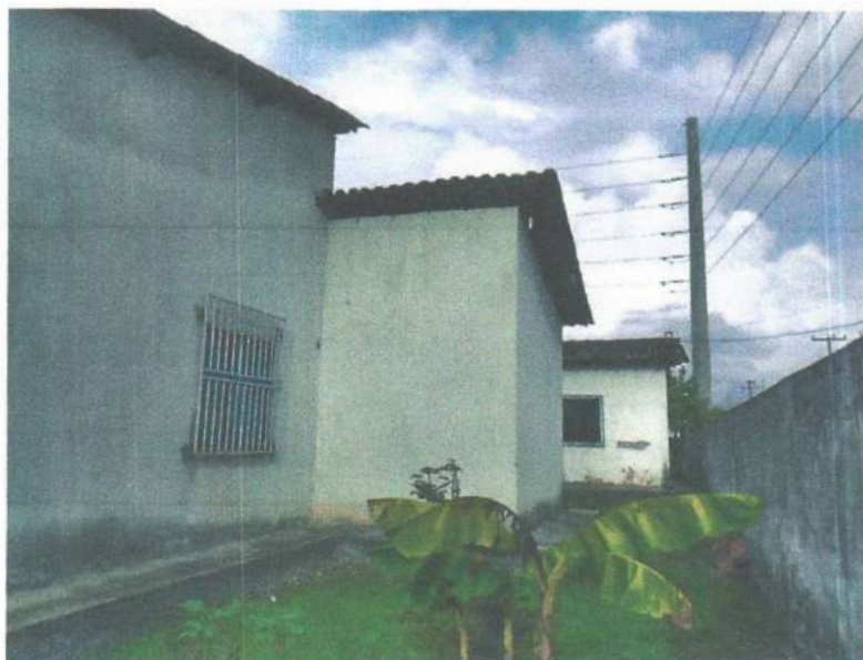
Imagem 9 – Fachada da escola com pintura danificada
