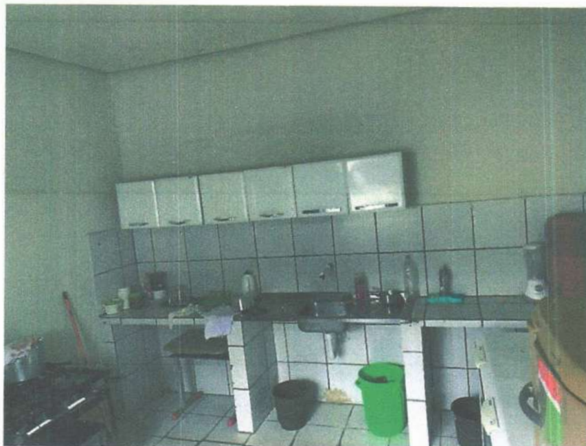
Imagem 23 – Cozinha com pintura danificada
