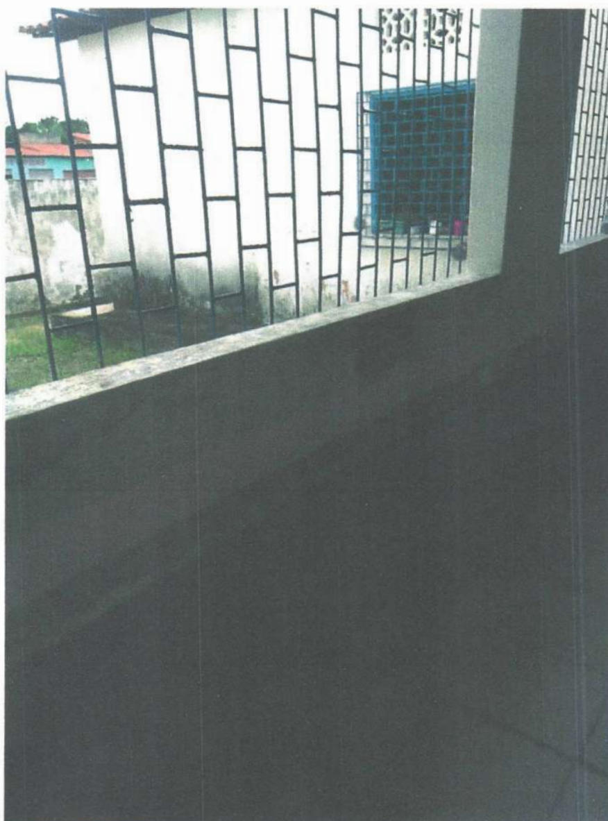
Imagem 18 – Pintura interna danificada
