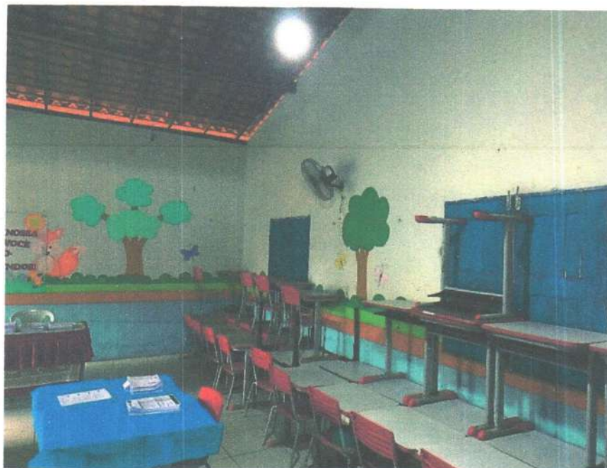
Imagem 19 – Pintura interna danificada
