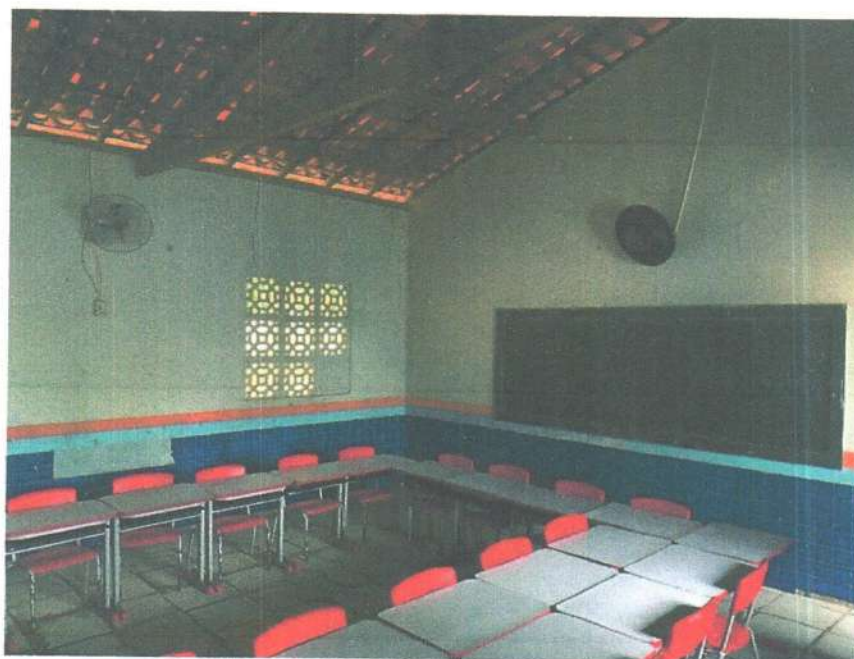
Imagem 27 – Pintura interna danificada
