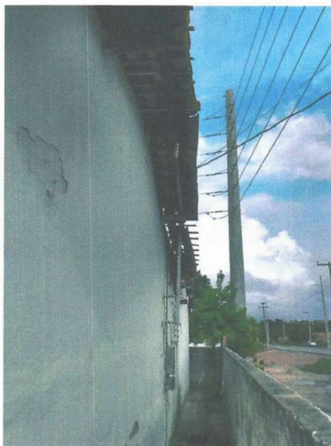
Imagem 8 – Fachada da escola com telhado danificado
