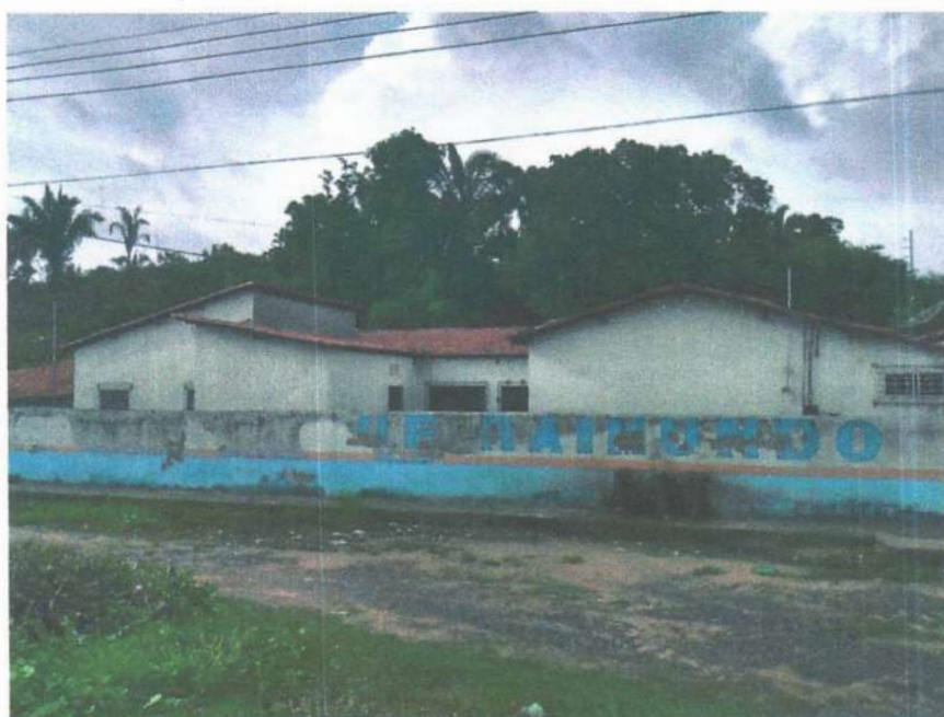
Imagem 2 – Pintura muro externo danificada
