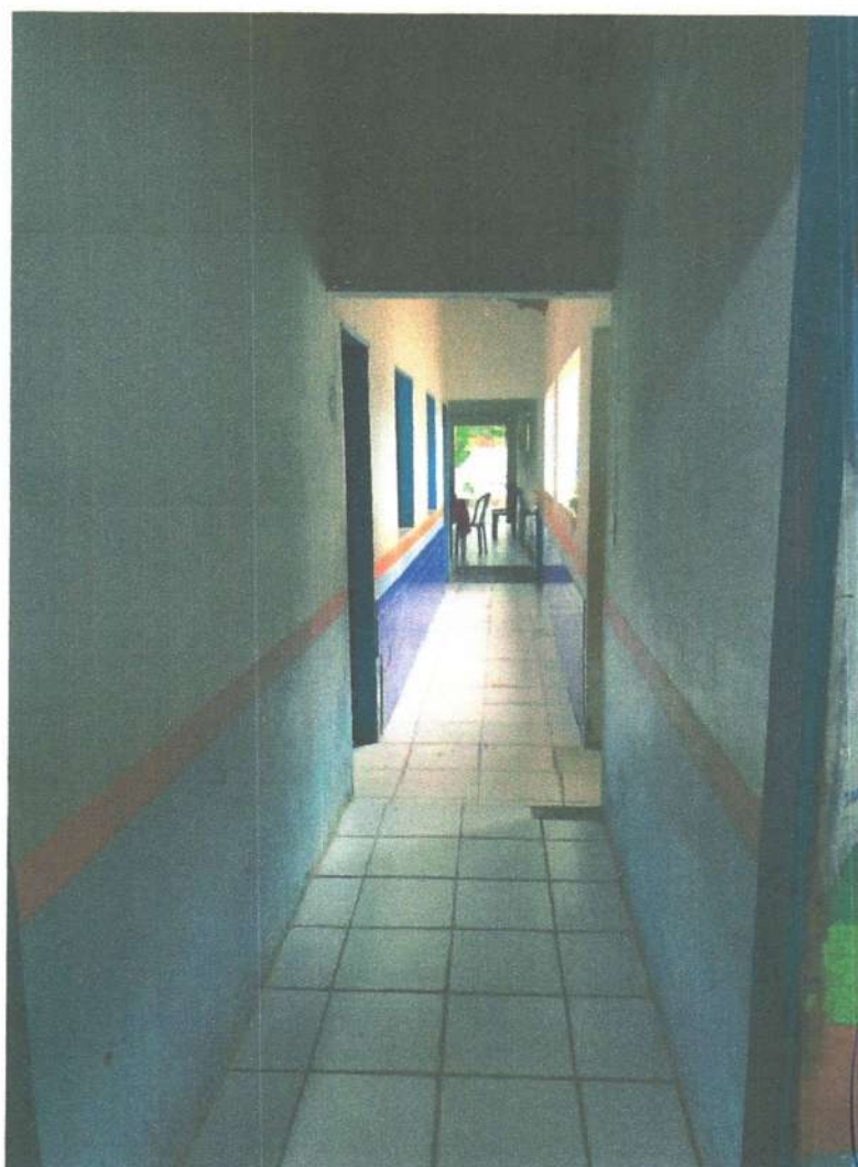
Imagem 20 – Pintura interna danificada
