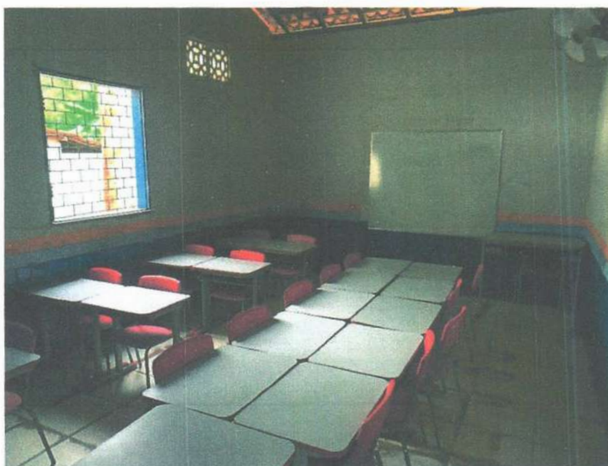
Imagem 21 – Pintura interna danificada
