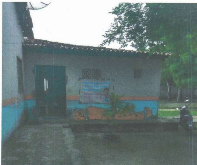
Imagem 5 – Entrada da escola com pintura danificada
