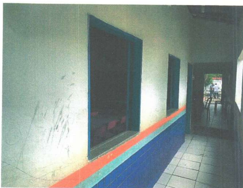
Imagem 26 – Pintura interna danificada
