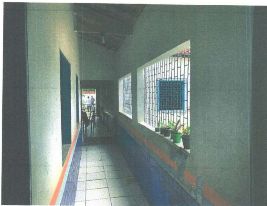
Imagem 25 – Pintura interna danificada
