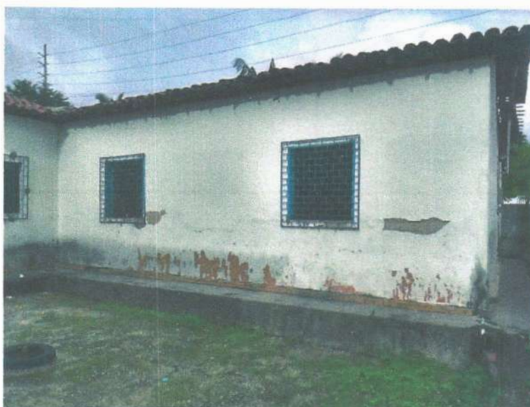
Imagem 13 – Pintura e telhado danificados
