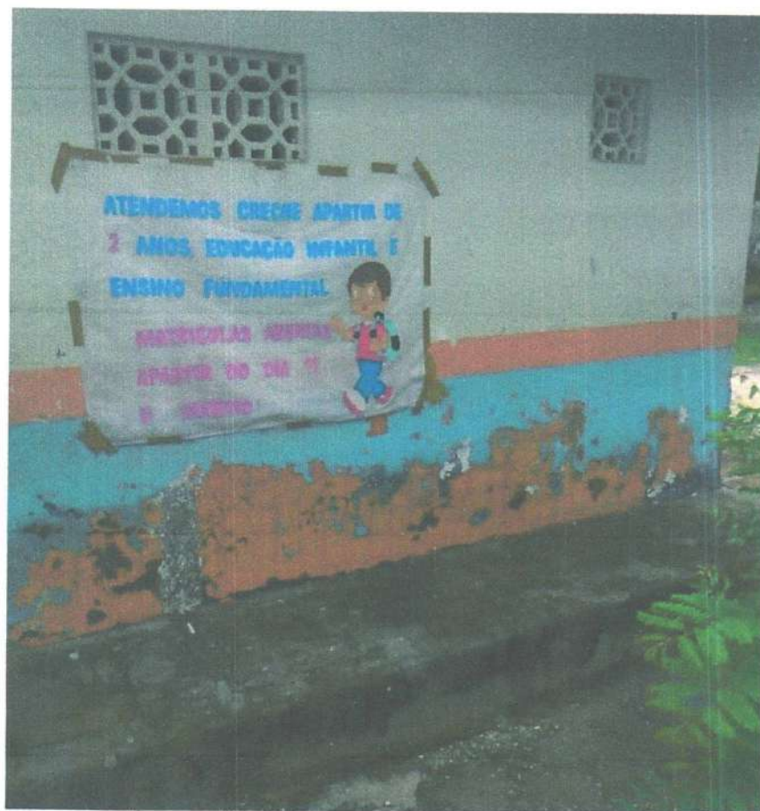
Imagem 15 – Pintura na entrada da escola danificada
