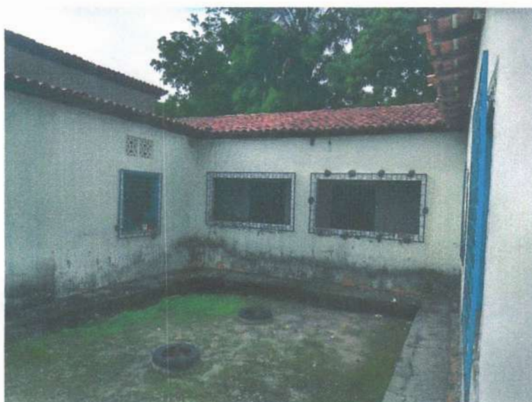
Imagem 14 – Pintura e telhado danificados
