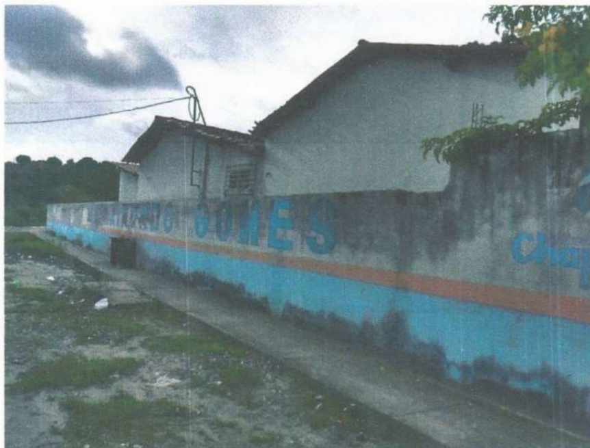
Imagem 1 – Pintura muro externo danificada
