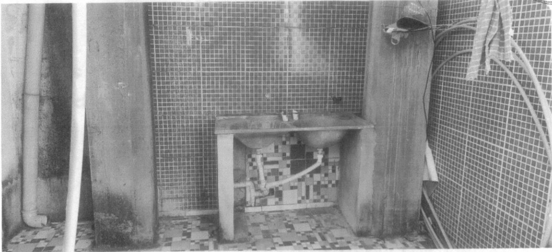
Lavanderia Fonte: Acervo Técnico (2021)
