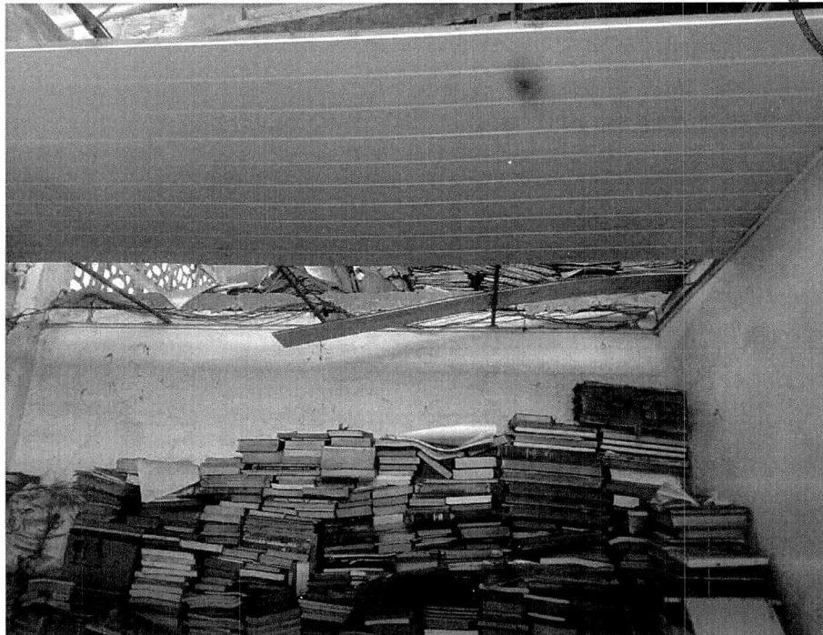
Imagem 03 - Forro PVC com avarias
