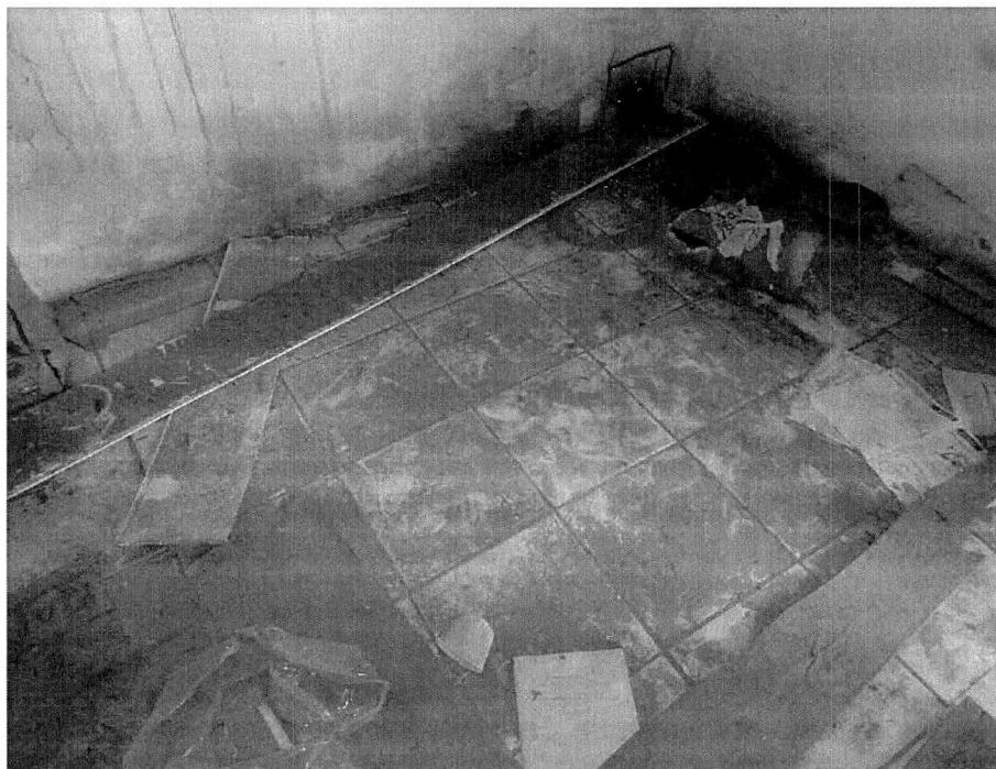
Imagem 04 - Piso cerâmico com avarias
