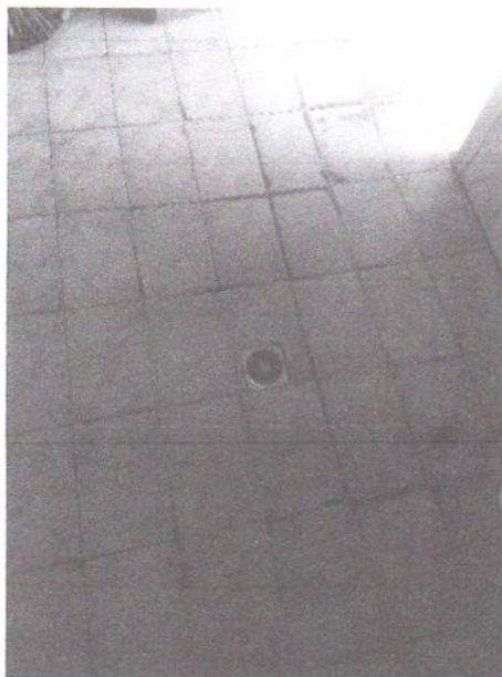
Imagem 12 – revestimento cerâmico danificada.
