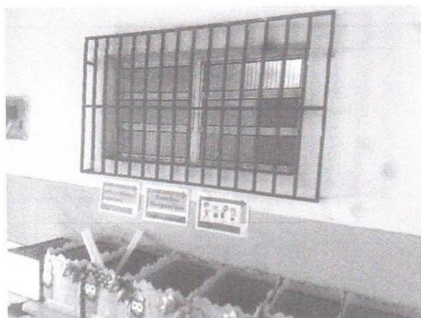
Imagem 16 – pintura gradil danificada.
