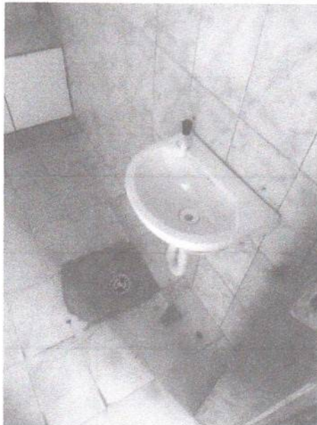
Imagem 12 – revestimento cerâmico danificada.
