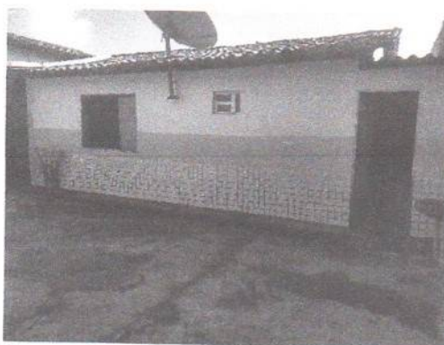
Imagem 06 – contra piso pátio, pintura e telhado danificada.
