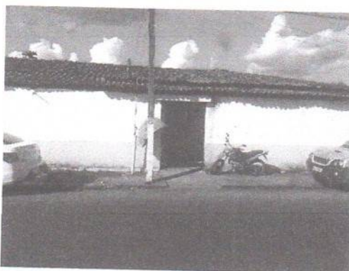
Imagem 01 – entrada da escola pintura externo danificada
