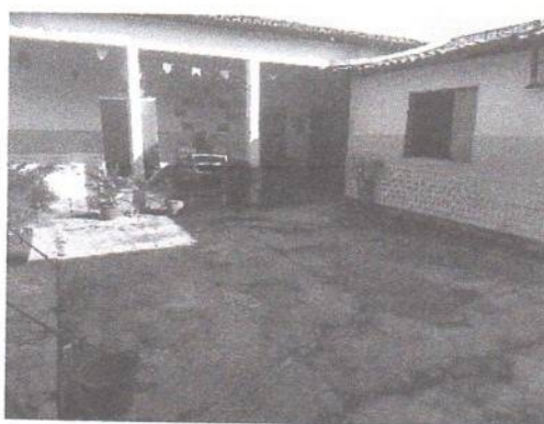
Imagem 05 – contra piso pátio danificado
