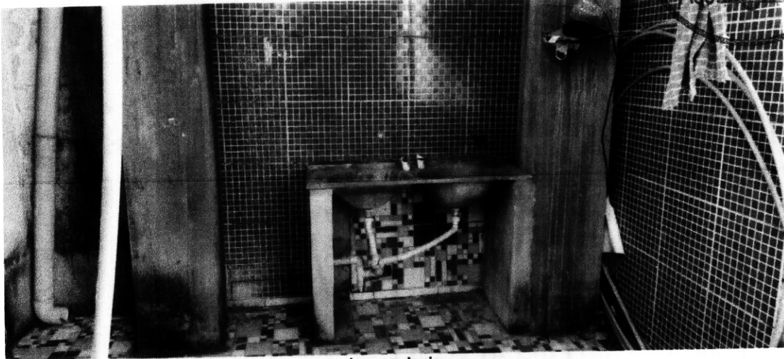
Lavanderia Fonte: Acervo Técnico (2021)
