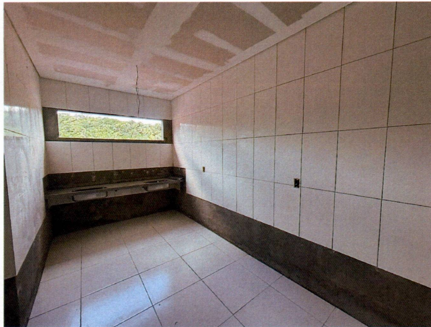
Imagem 9 – Execução do revestimento cerâmico da cozinha e assentamento das bancadas em granito.
